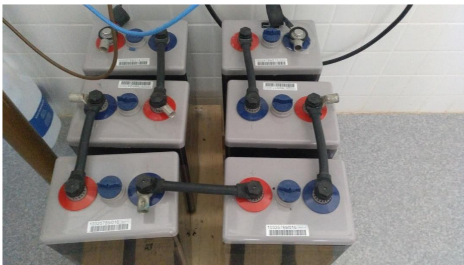
Figura 4.11. – Banco de baterías. Fuente propia.
