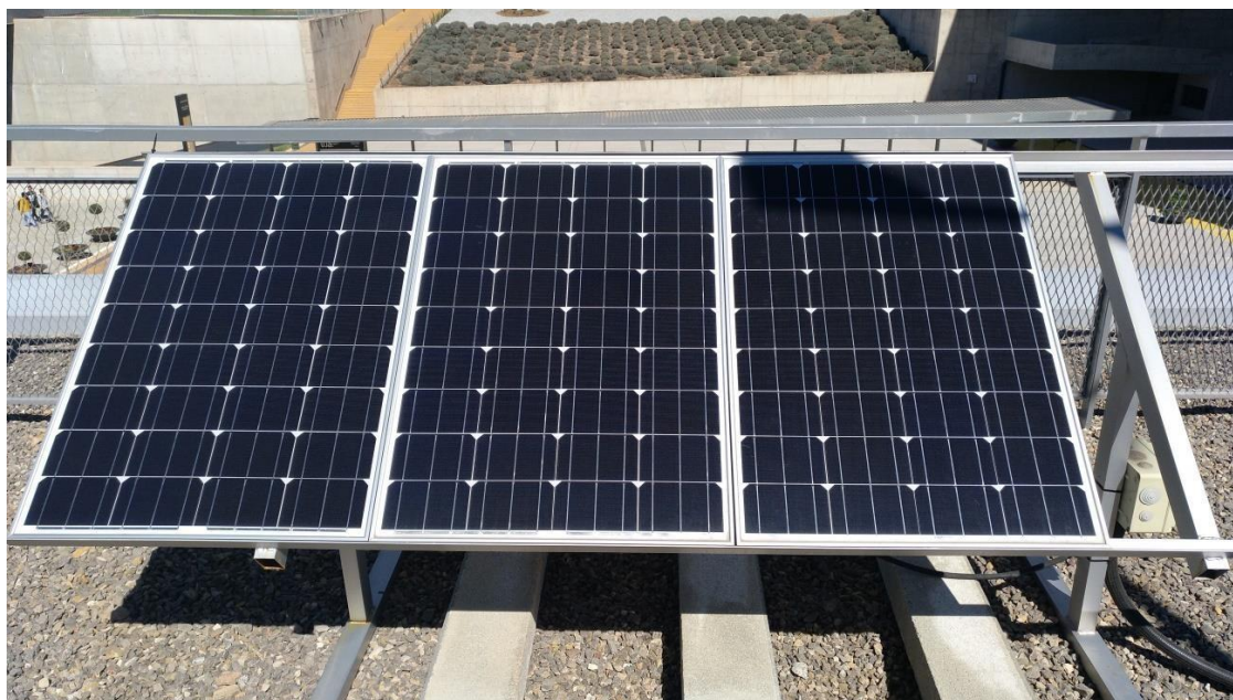
Figura 4.1. – Módulos solares montados y conectados. Fuente propia.
