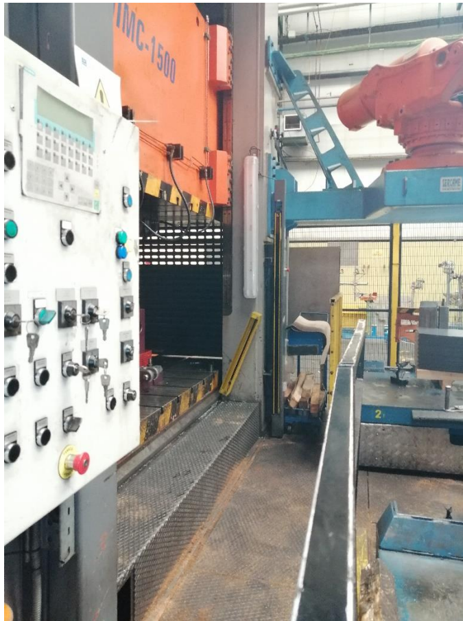
Imagen 20. Barreras fotoeléctricas situadas en el interior de la prensa.
