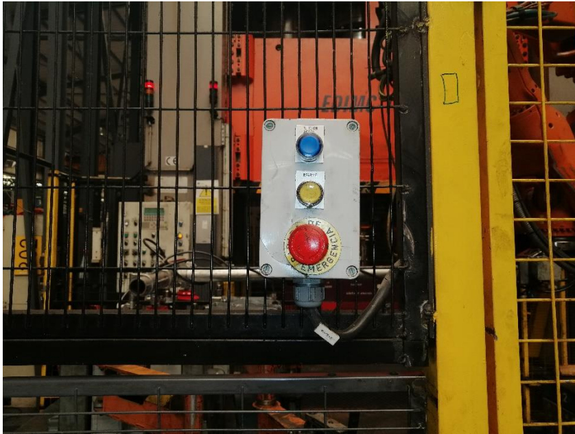
Imagen 18. Seta de emergencia.
