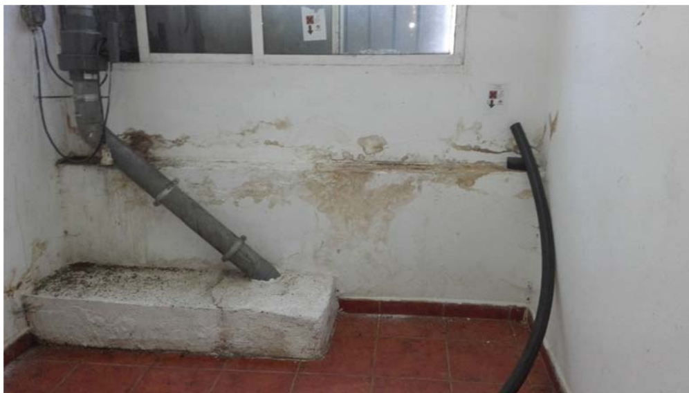
Figura 5.42. Paredes en mal estado.
