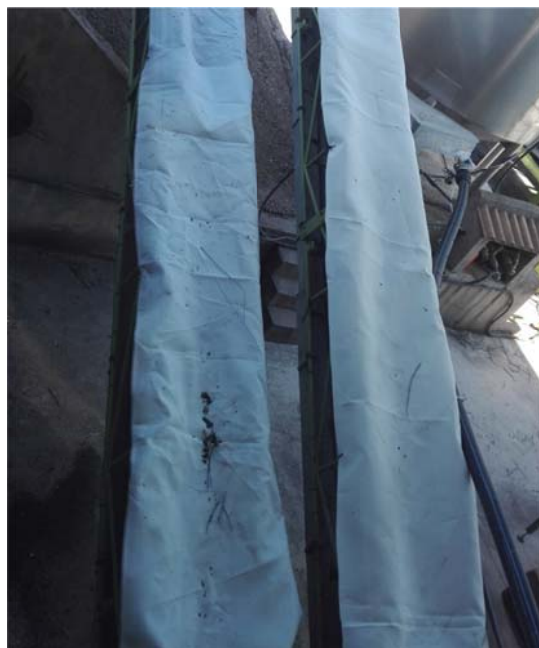
Figura 5.29. Fundas de cintas transportadoras y tolvas de recepción de aceituna.
