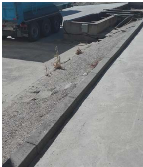
Figura A2.18. Valla de protección inexistente
