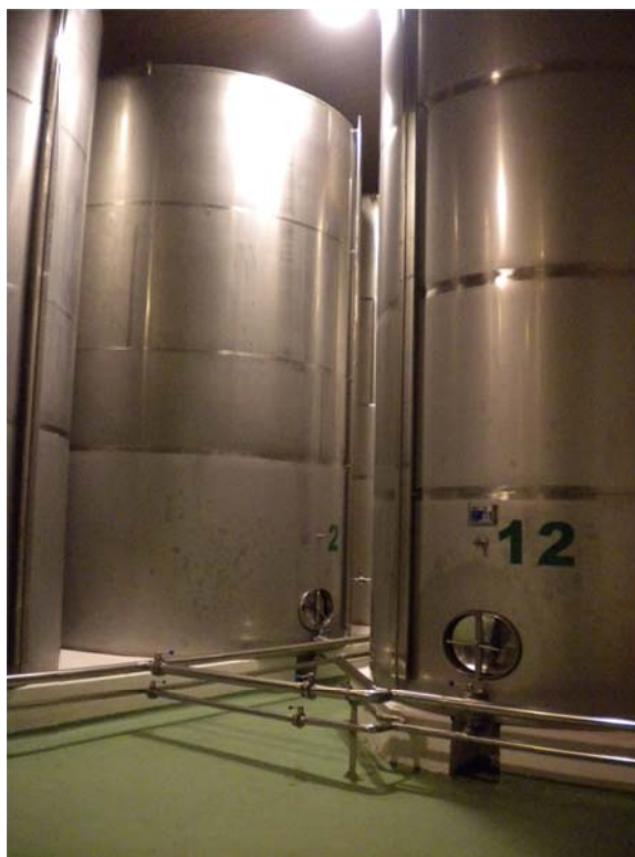
Figura 5.31. Exterior de los depósitos de aceite.
