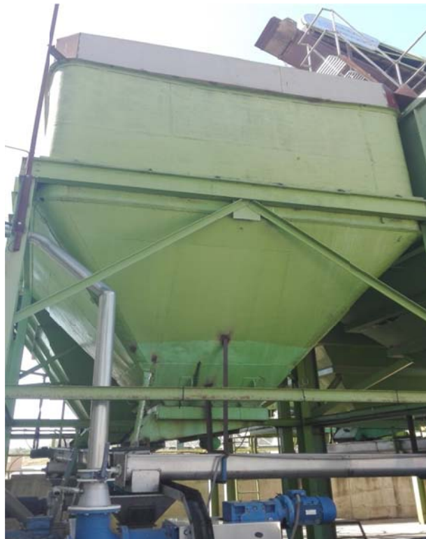
Figura A1.6. Molino metálico de martillo y tolvas de almacenamiento temporal de aceituna
