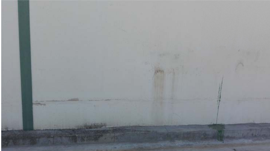
Figura A2.19. Mal aspecto del exterior del puesto de trabajo.
