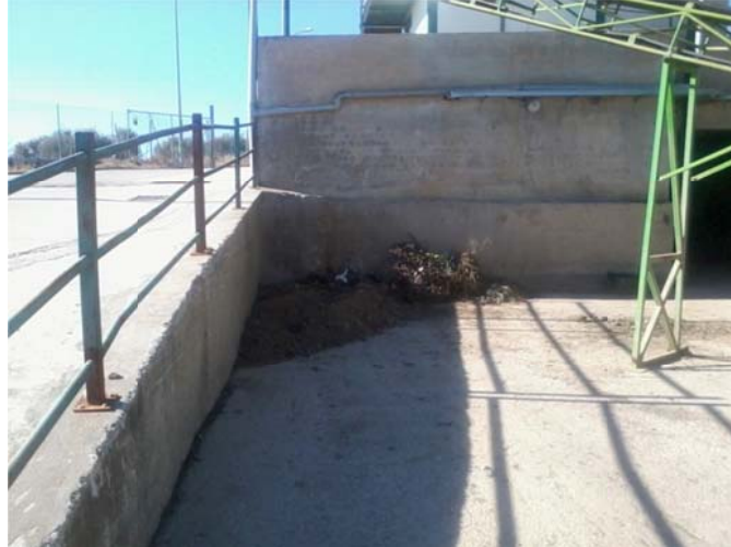
Figura A2.7. Ausencia de delimitación e indicadores de peligro.
