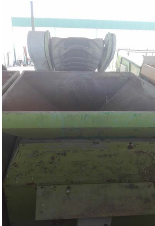
Figura 5.38. Presencia de suciedad en las máquinas limpiadoras y lavadoras de aceituna.
