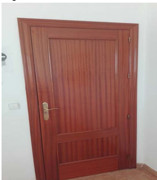
Figura A2.24. Puerta de salida sin indicación de salida de emergencia.
