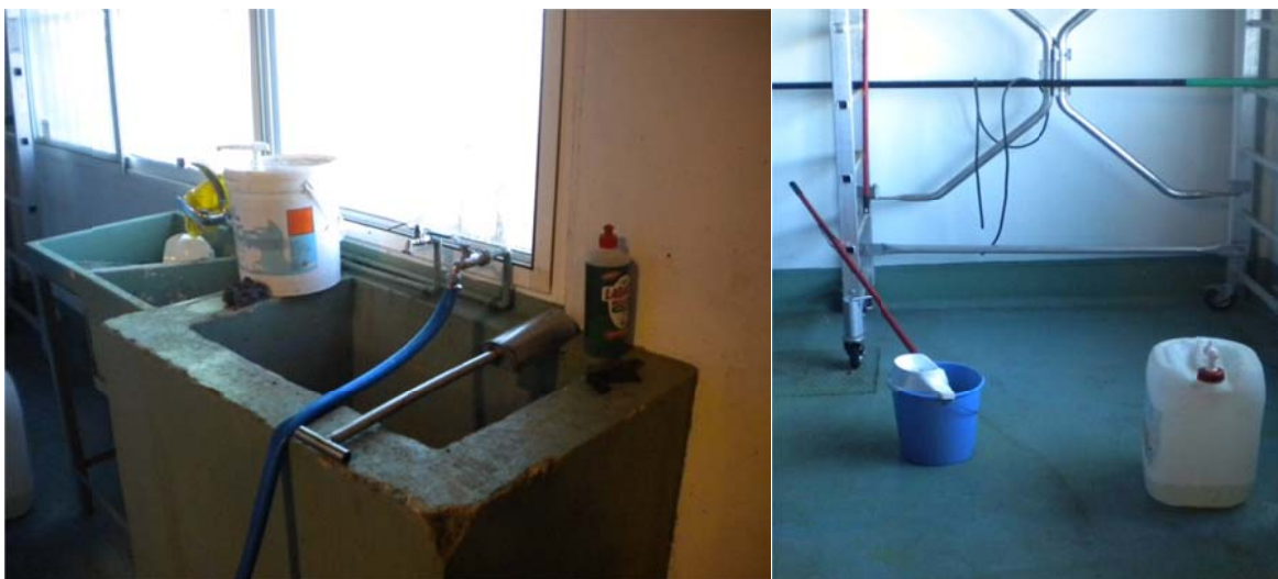
Figura A2.16. Disposición incorrecta de los elementos de limpieza
