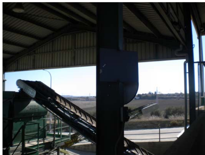
Figura A2.6. Ausencia de indicadores del tipo de aceituna en las tolvas de recepción
