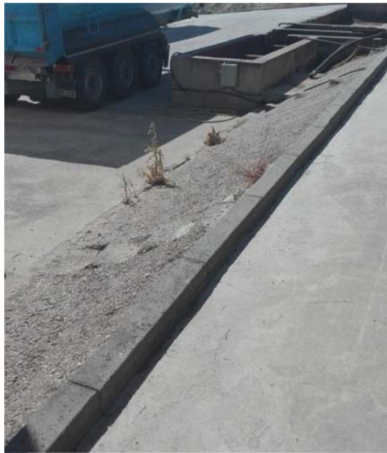
Figura 5.40. Valla de protección inexistente.
