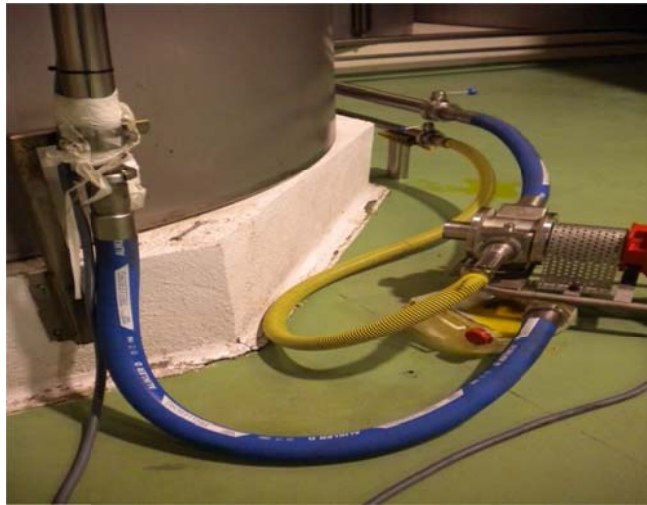
Figura A2.21. Disposición incorrecta de los elementos de trabajo
