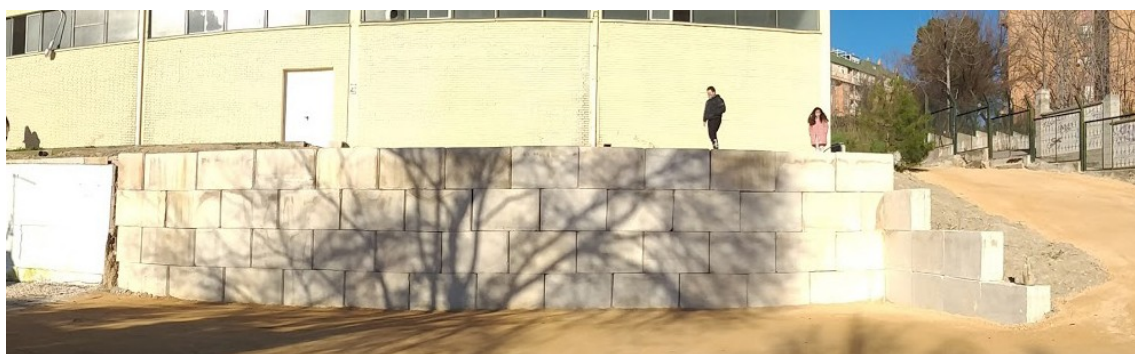
I36) Muro sin pintar: foto de elaboración propia
