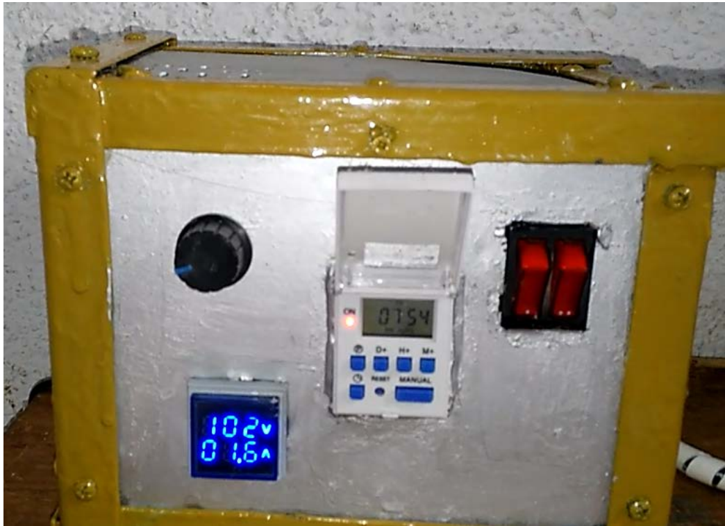
Ilustración 11. Vista principal del cuadro eléctrico de la bomba hidráulica de la prueba final. Fuente: Elaboración propia.
