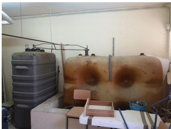
Imagen 3: Detalle del depósito de almacenamiento.
