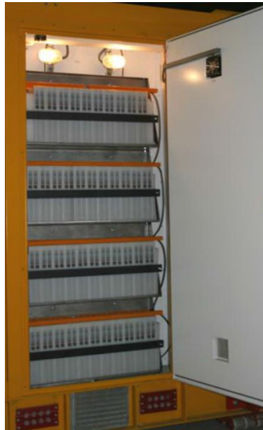
Ilustración 4.48.- Compartimento de las baterías de una subestación de tracción móvil
