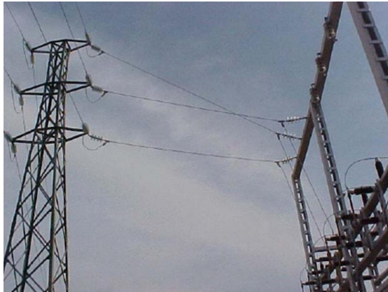
Ilustración 4.10.- Apoyo con derivación abasteciendo una subestación de tracción
