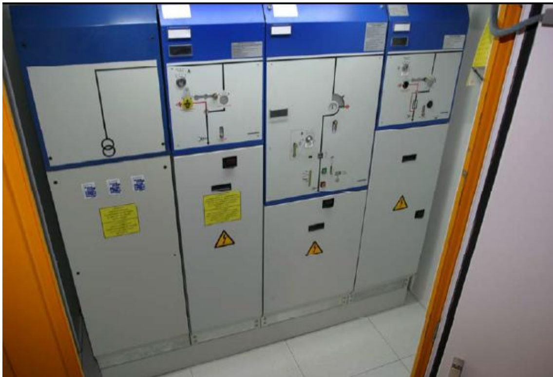
Ilustración 4.45.- Compartimento de seccionamiento, protección y medida de la subestación de tracción móvil
