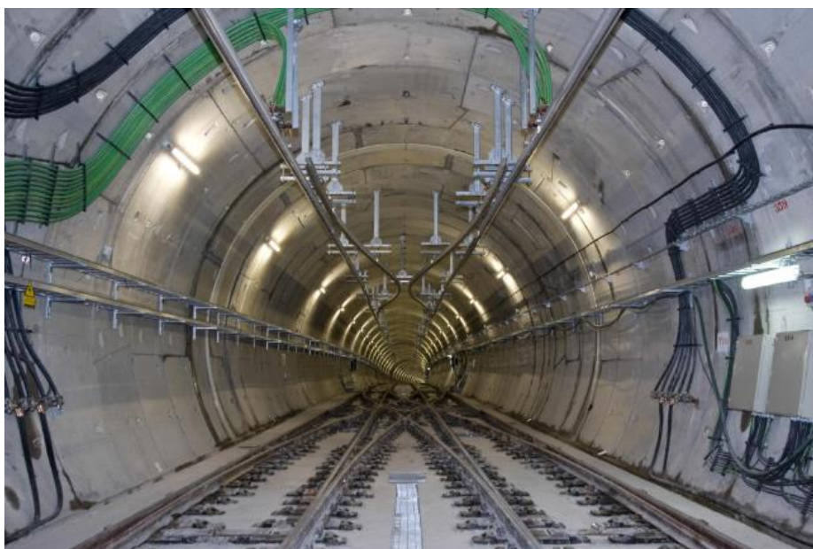
Ilustración 4.59.- Catenaria rígida con aguja aérea en un túnel
