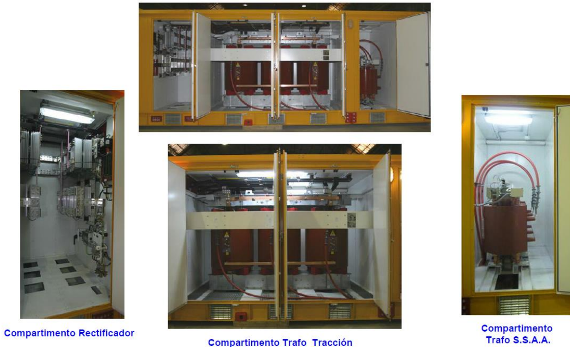
Ilustración 4.44.- Compartimento de rectificador y transformadores de una subestación de tracción móvil
