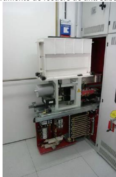
Ilustración 4.47.- Detalle del disyuntor extrarápido extraíble de las celdas de los feeders
