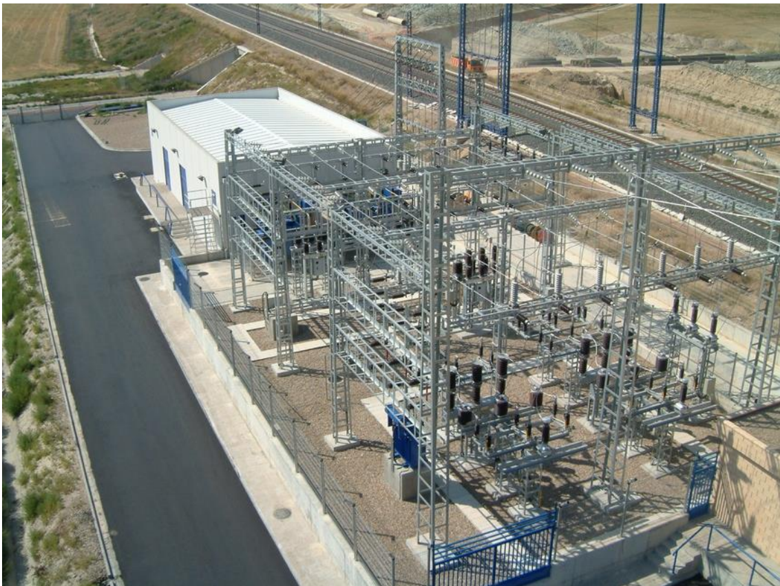
Ilustración 3.14.- Subestación de tracción
