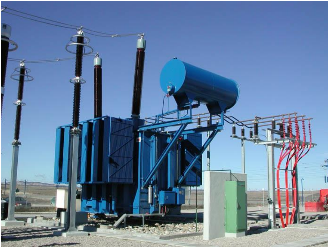
Ilustración 3.15.- Transformador de tracción
