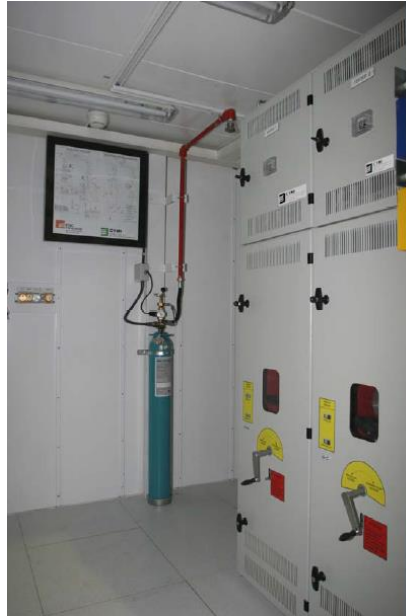
Ilustración 4.46.- Compartimento de feeders de una subestación de tracción móvil
