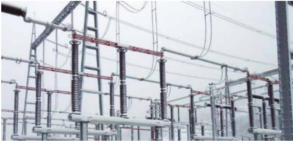
Ilustración 4.29.- Seccionador de entrada de línea
