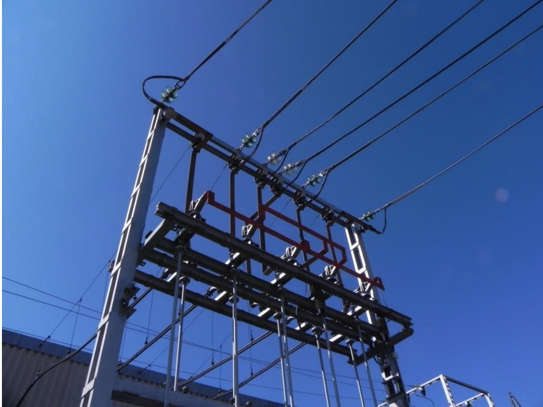
Ilustración 4.40.- Pórtico de catenaria y feeders para subestaciones de tracción en corriente alterna
