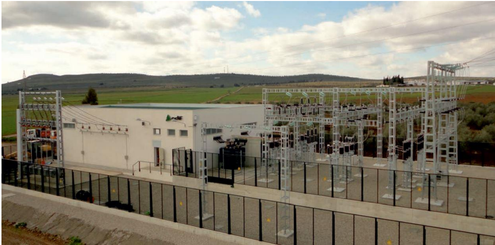
Ilustración 4.11.-Subestación de tracción fija
