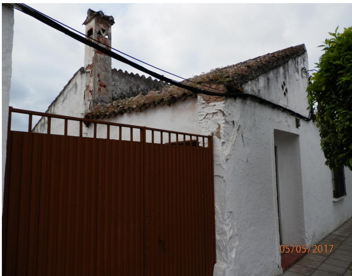
Foto: Vivienda abandonada de colono, con tejado en mal estado. Elaboración propia
