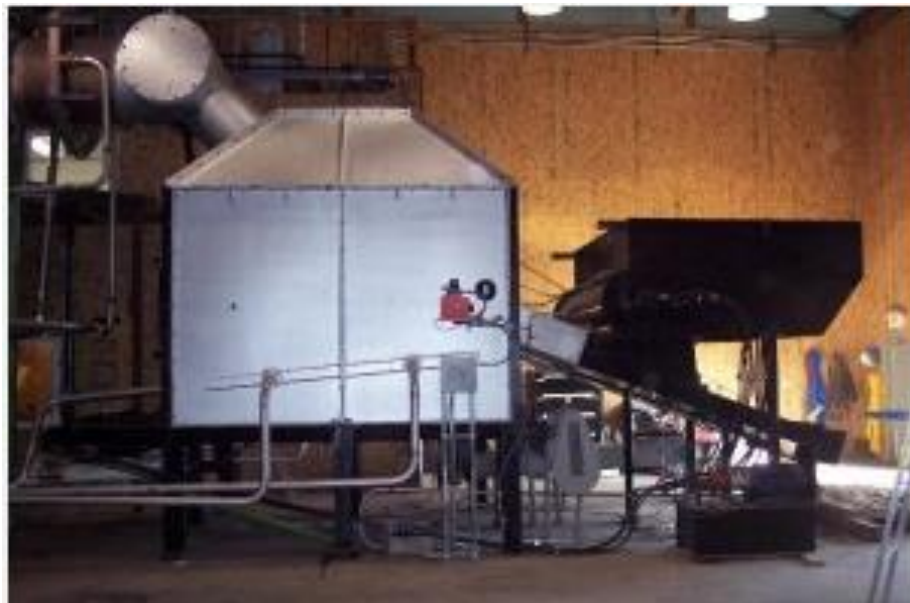
Figura 2.18 Vista lateral del gasificador y depósito de combustible. Fuente: COALTEC ENERGY
