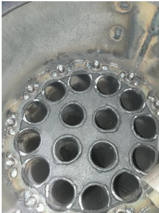
Figura 4.18 Interior zona refrigeración
