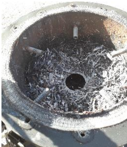
Figura 5.6 Zona de combustión e inyectores cubierta de cenizas
