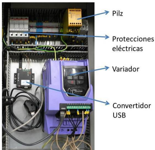
Figura 27: Interior armario principal.
