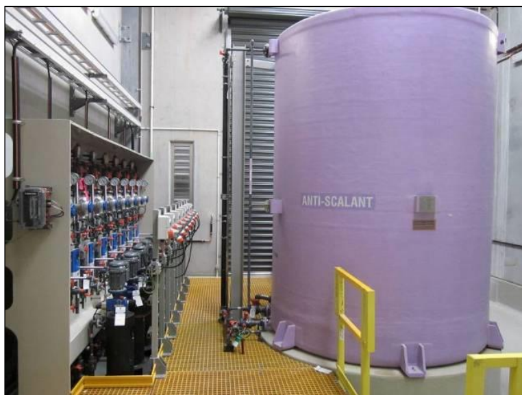
Figura 6.4 Dosificación química. Planta desaladora de agua de mar por OI, Perth (Australia)
