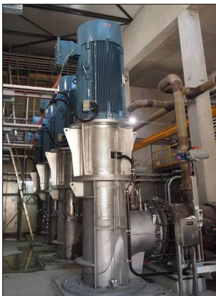
Figura 5.1. Captación de agua de mar. Desaladora de agua de mar de Perth (Australia).
