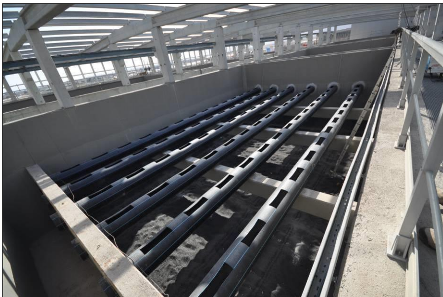
Figura 6.1. Filtros de Gravedad Planta desaladora de agua de mar por OI, Águilas (España)
