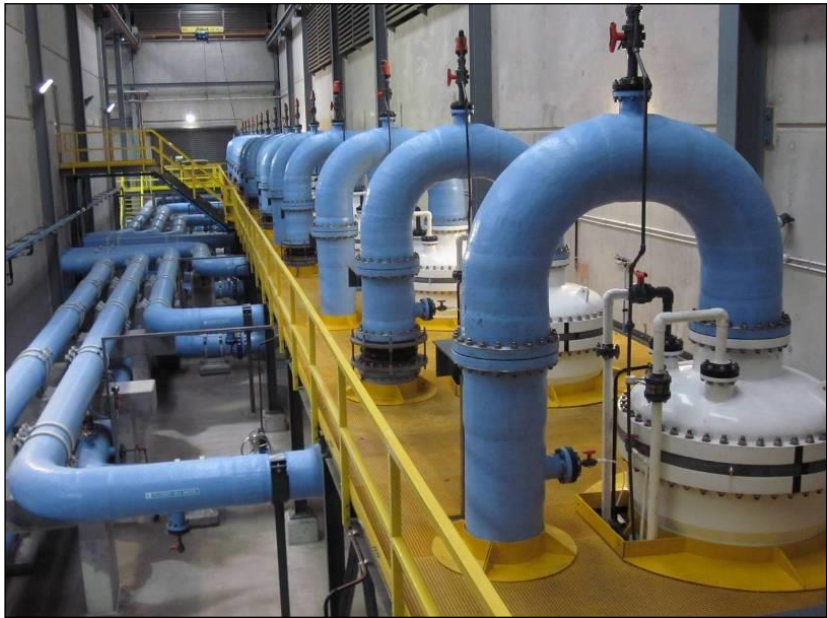
Figura 6.3. Filtros de Cartuchos. Planta desaladora de agua de mar por OI, Perth (Australia).
