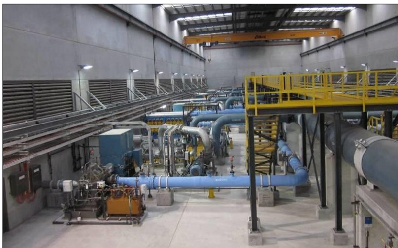
Figura 7.1 Bombeo de alta presión y sistema ERD. Planta desaladora de agua de mar por OI, Perth (Australia).
