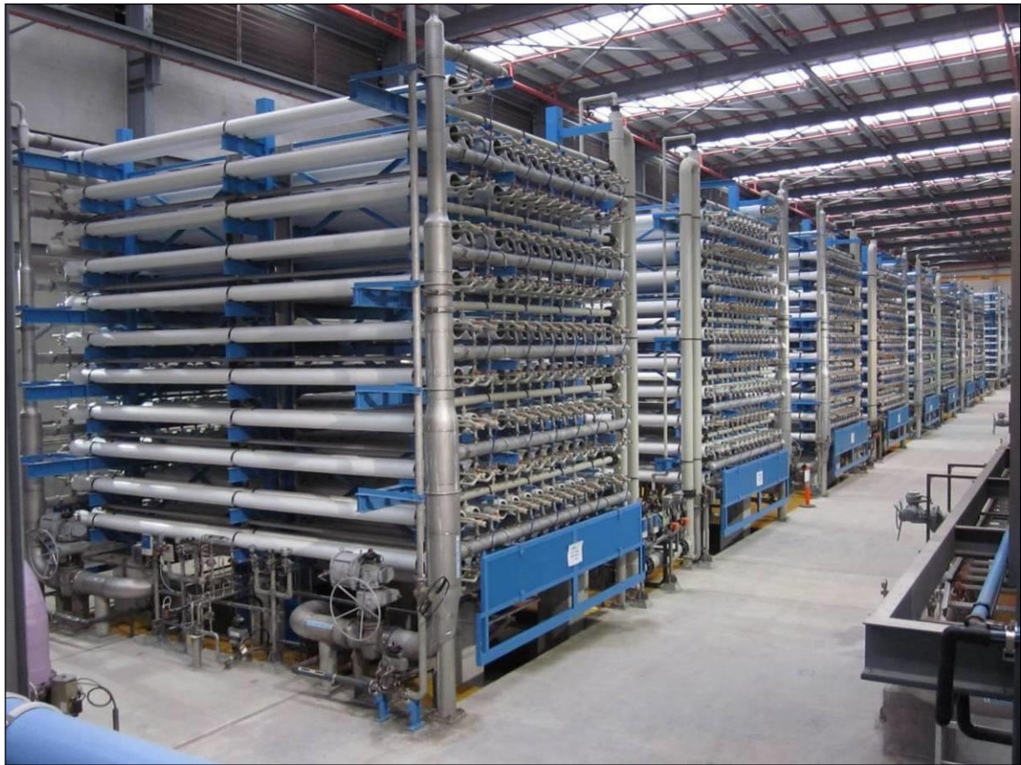
Figura 7.7 Bastidores de OI. Planta desaladora de agua de mar por OI, Perth (Australia)
