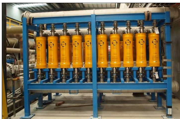
Figura7.3 Sistema recuperador de energía ERI PX-260 instalado en la planta desaladora por OI de Perth (Australia).
