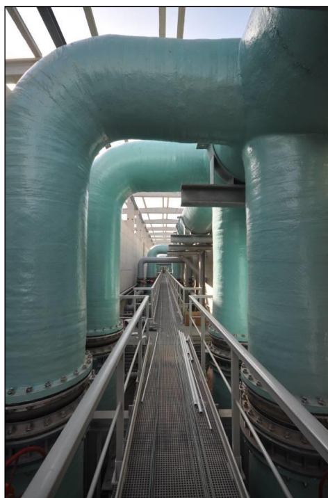
Figura 6.2. Filtro de gravedad Colector. Desaladora de agua de mar por OI, Águilas (España)
