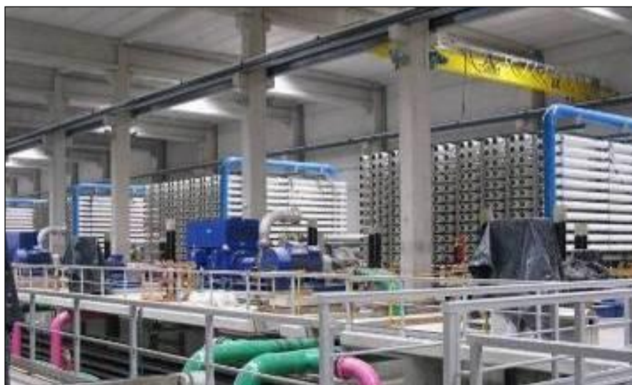
Figura 7.8 Bastidores de OI. Planta desaladora de agua de mar por OI, Águilas (España).
