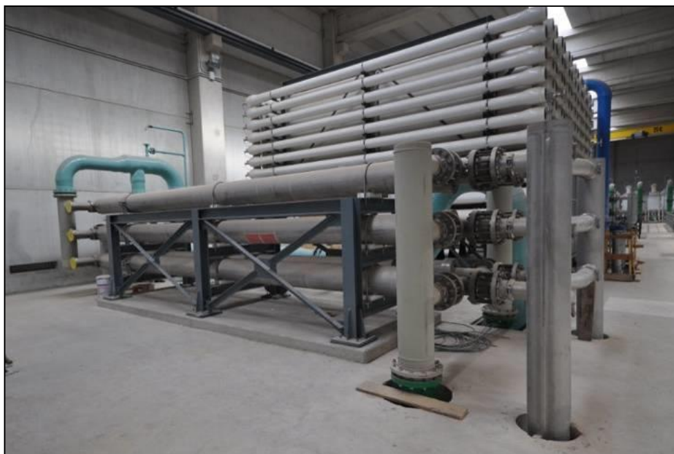
Figura7.4 Recuperador de energía tipo Dweer (Flowserve) en la IDAM de Águilas (España).
