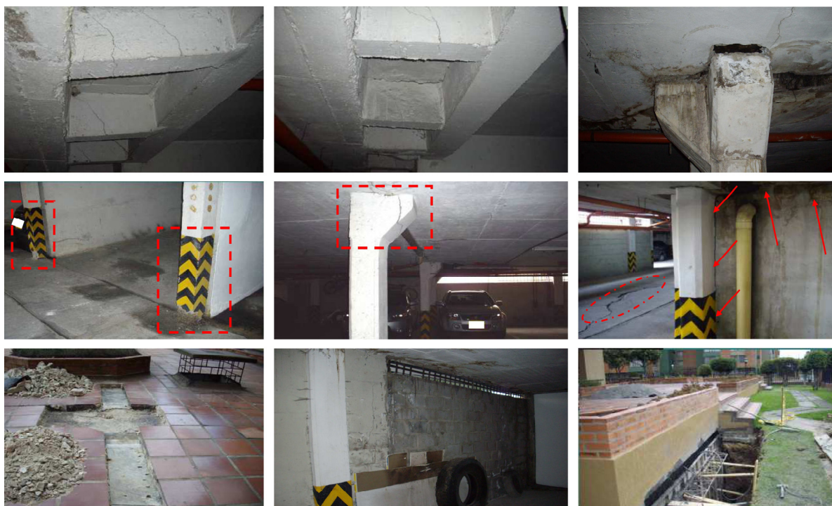
Figura 36. Patologías estructurales de una edificación en el año 2019 en una zona de subsidencia (parte occidental de Ciudad Salitre) en la ciudad de Bogotá. Las imágenes proporcionadas por Gustavo Matiz (Ingeniero Topógrafo), Leonardo Ruiz Arce (Ingeniero Civil) y Jorge E. Ruiz Bastidas (Arquitecto).
