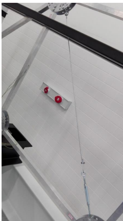
Figura 5.51: Tirante de acero y tensor de su extremo.
