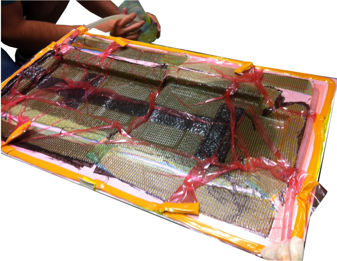
Figura 96. Inicio de proceso de infusión en la fabricación de la tapa del contenedor.
