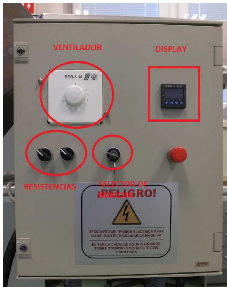
Ilustración 57: Cuadro eléctrico túnel de secado
