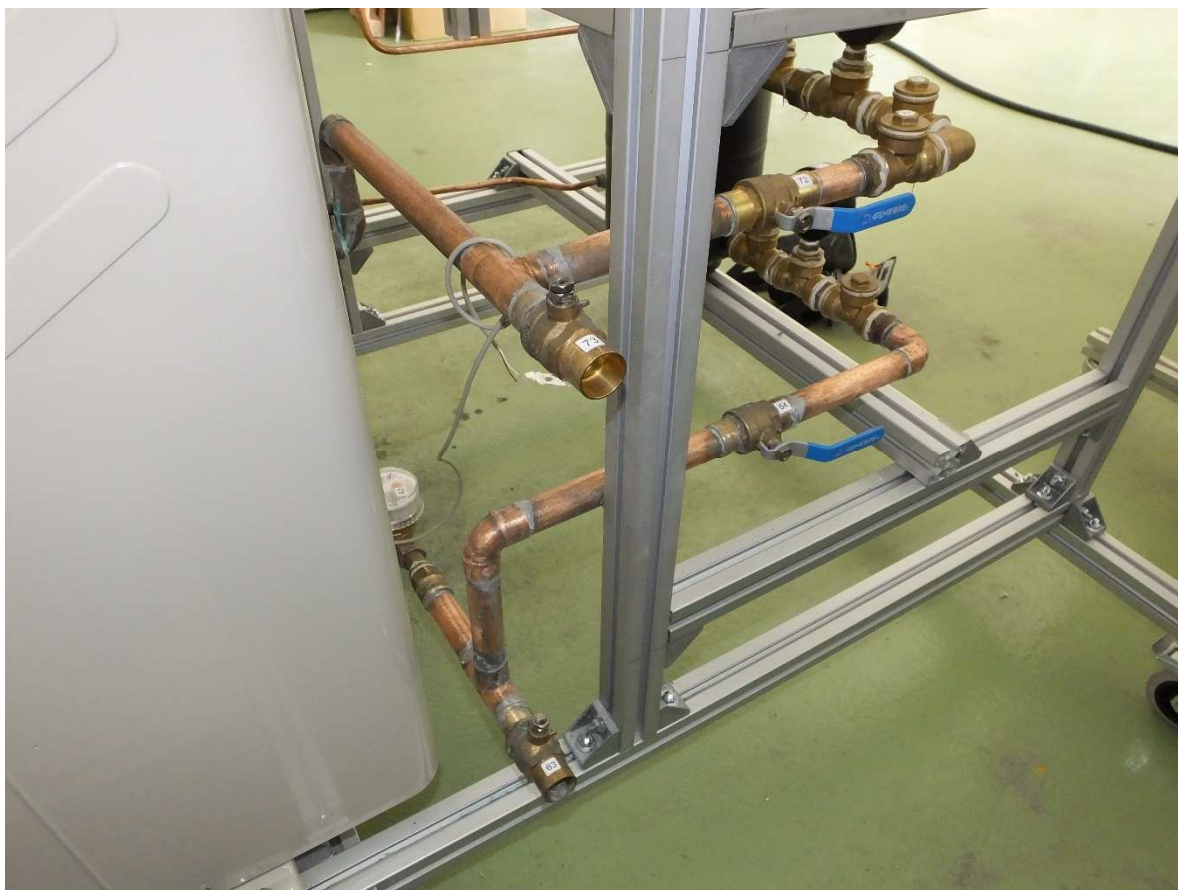
Ilustración 42: Localización válvulas 63, 73, 64 y 72
