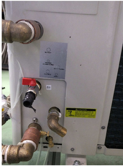
Ilustración 27: Válvula mariposa carga/desagüe chiller
