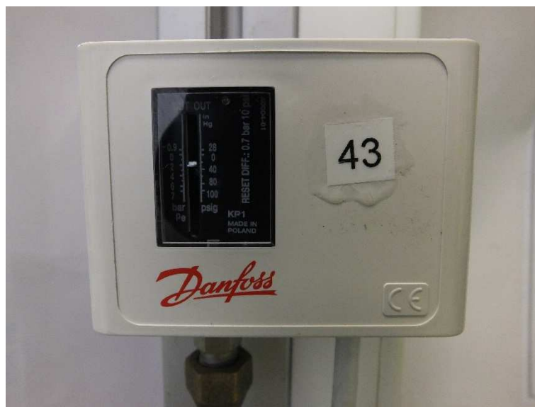
Ilustración 21: Presostato de baja
