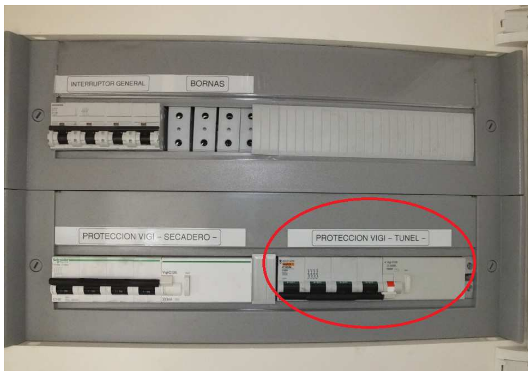
Ilustración 56: Cuadro eléctrico túnel de secado
