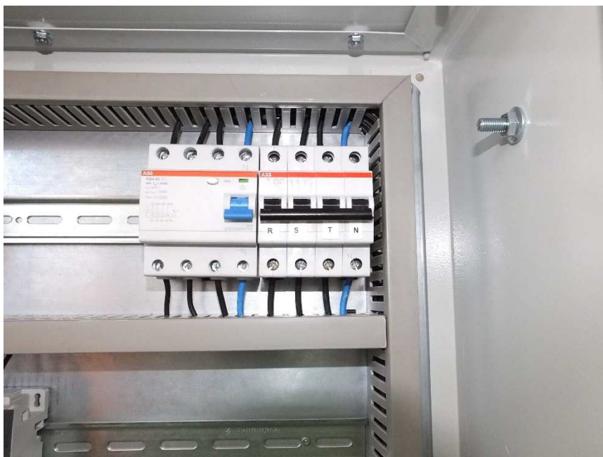
Ilustración 47: Interruptor general y diferencial
