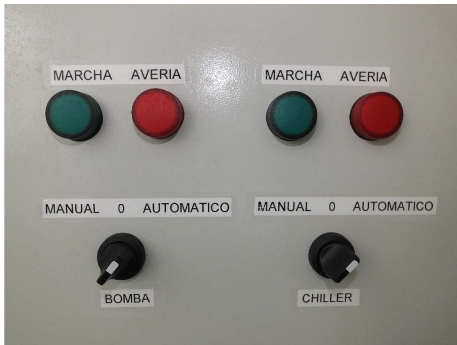
Ilustración 51: Posición automático para chiller y bomba
