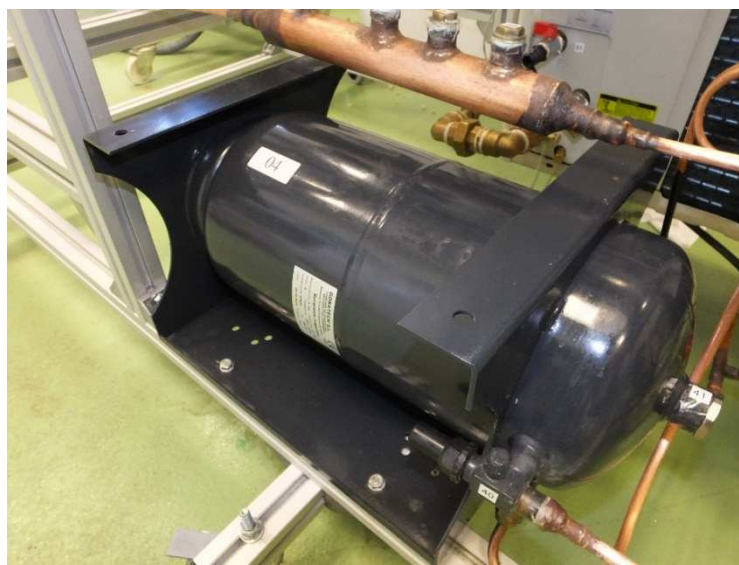
Ilustración 4: Depósito de refrigerante
