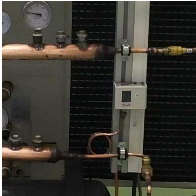
Ilustración 55: Presostato de baja
