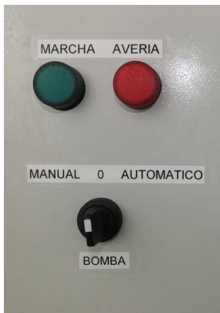
Ilustración 62: Posición Cero bomba
