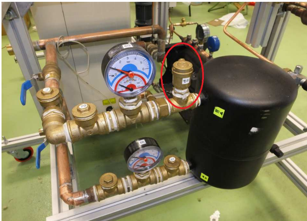
Ilustración 45: Localización purgador de aire
