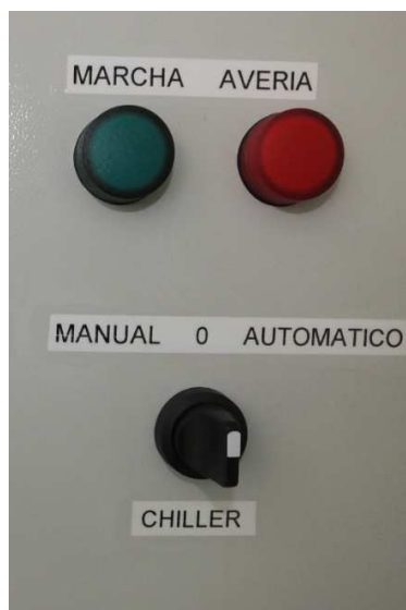
Ilustración 64: Posición Cero chiller
