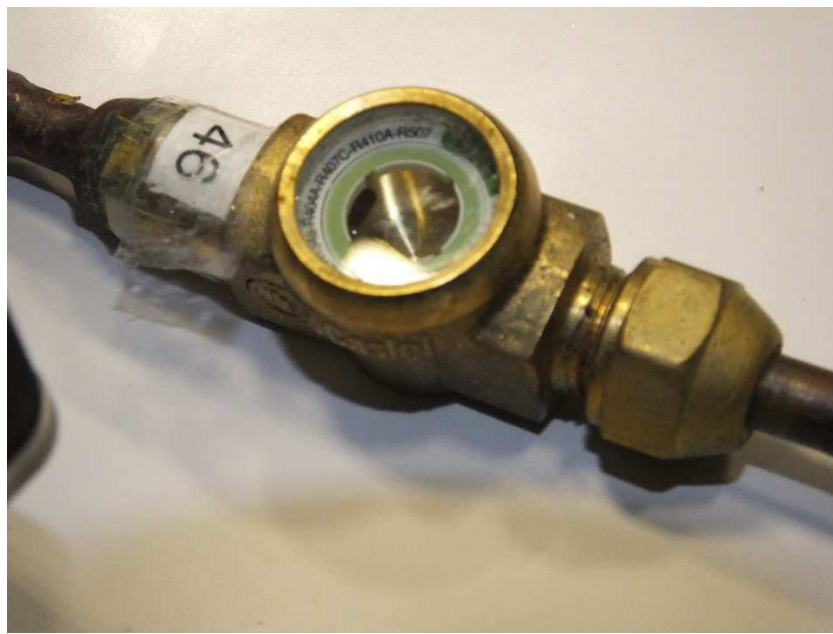
Ilustración 23: Visor líquido bomba refrigerante
