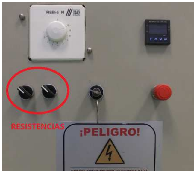
Ilustración 63: Resistencias Túnel de secado
