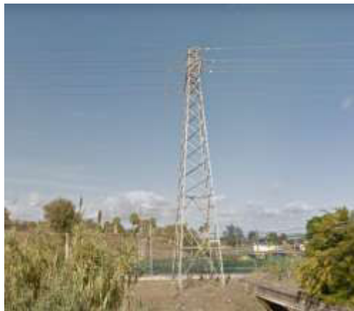
Figura 74: Torre de media tensión/ Reportaje propio
