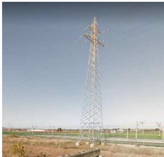
Figura 75: Torre de alta tensión/ Reportaje propio
