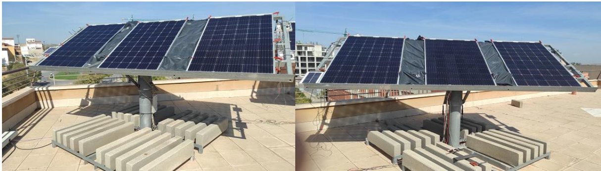
Figura 8. Estructura 1 y 2 de la Instalación en la terraza del edificio A3
