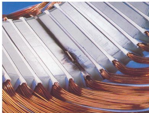
Ilustración AII. 3. Consecuencia de un mal aislamiento de las ranuras del motor.
