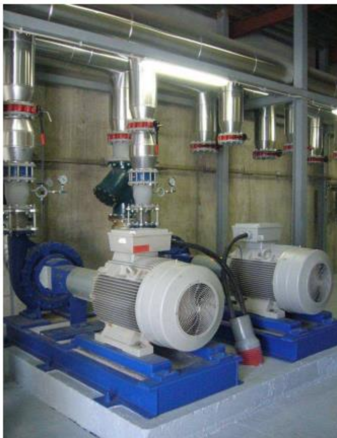
Ilustración 4.4 Estación de bombeo del sistema DHC Tub Verd de Mataró
