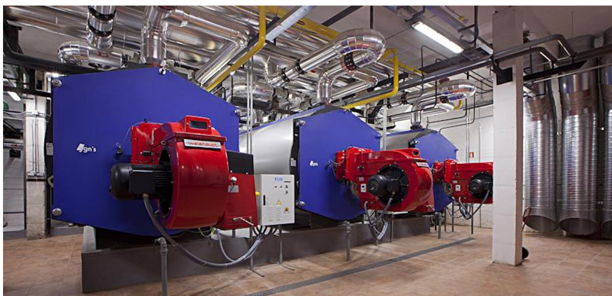
Ilustración 4.1 Sala de calderas centralizada.
