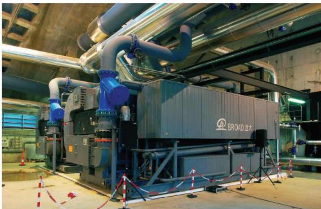
Ilustración 4.2 Central Fòrum: máquina de absorción de doble efecto de 4,5 MW [Districlima]
