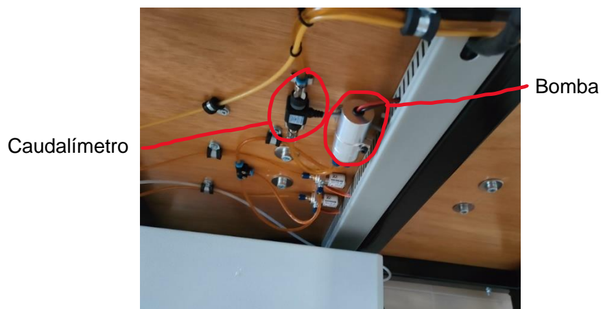
Ilustración 3.2.8 – Conjunto de bomba más caudalímetro.
