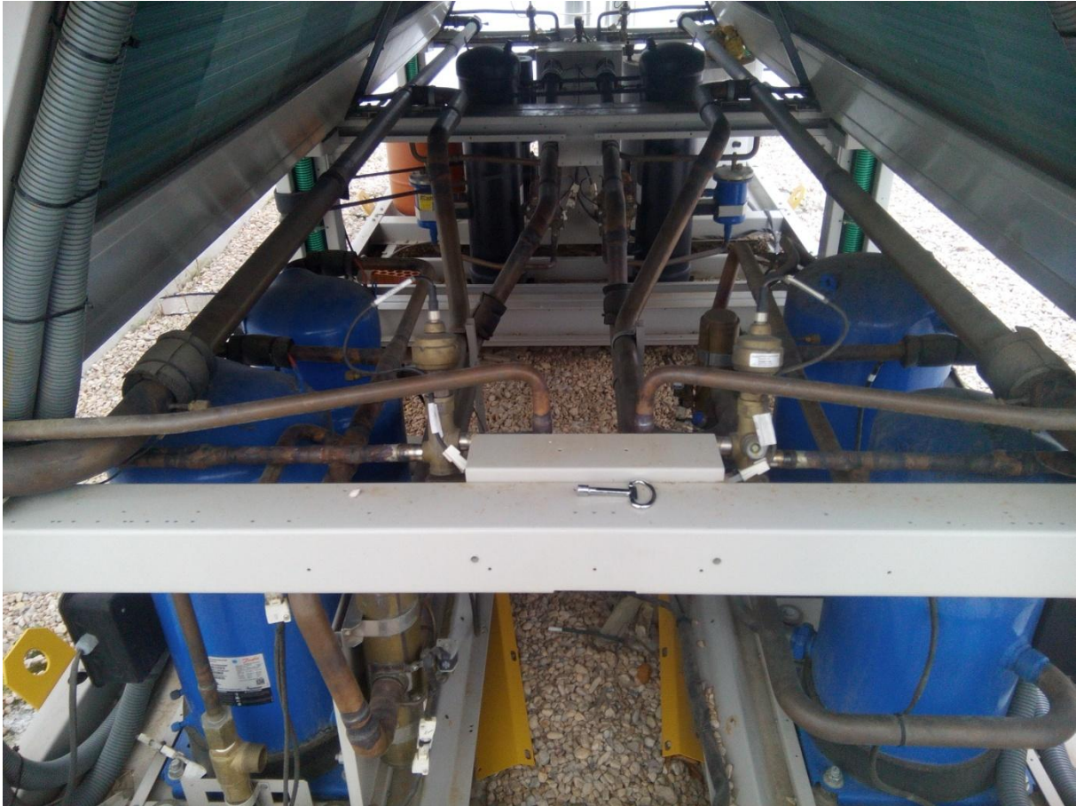
Ilustración 3. Planta enfriadora DAIKIN EWYQ230DAYNN
