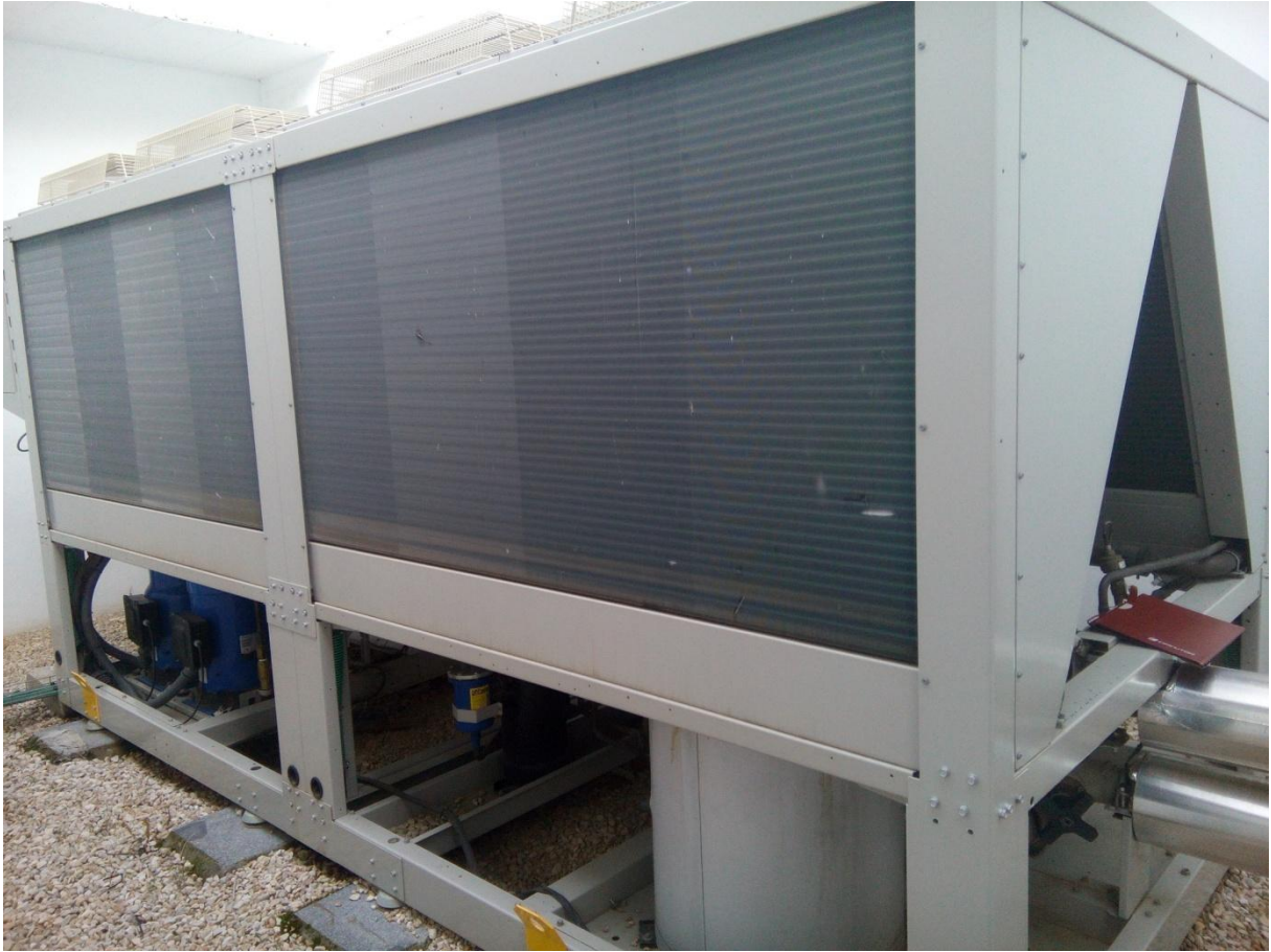
Ilustración 2. Planta enfriadora DAIKIN EWYQ230DAYNN
