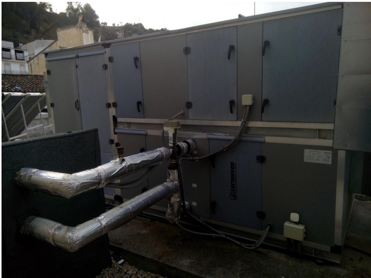
Ilustración 5. UTA (Unidad de Tratamiento de Aire)
