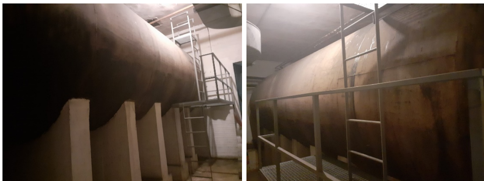
Figura 4.5 Silo de almacenamiento (Fuente: Elaboración propia)
