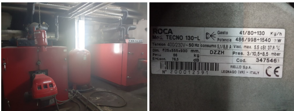
Figura 4.2 Calderas y Placa de características (Fuente: Elaboración propia)
