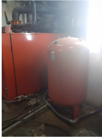
Figura 4.3 Vaso expansión Ibaiondo 500-AMR-B160I (Fuente: Elaboración propia)
