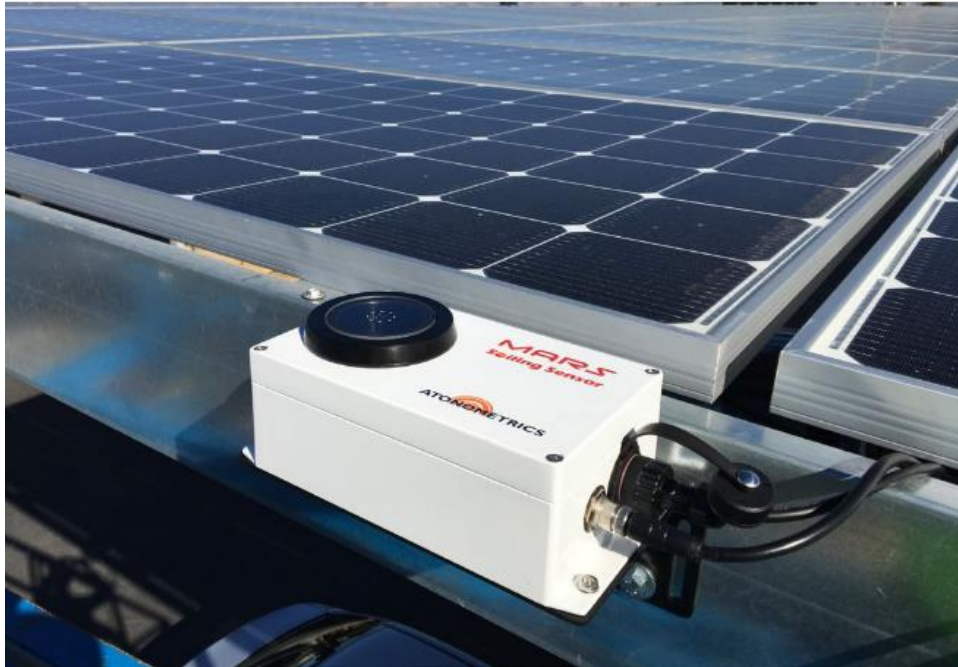
Figura 3.5. Sensor de soiling Mars instalado en la cubierta de un parking [44].
