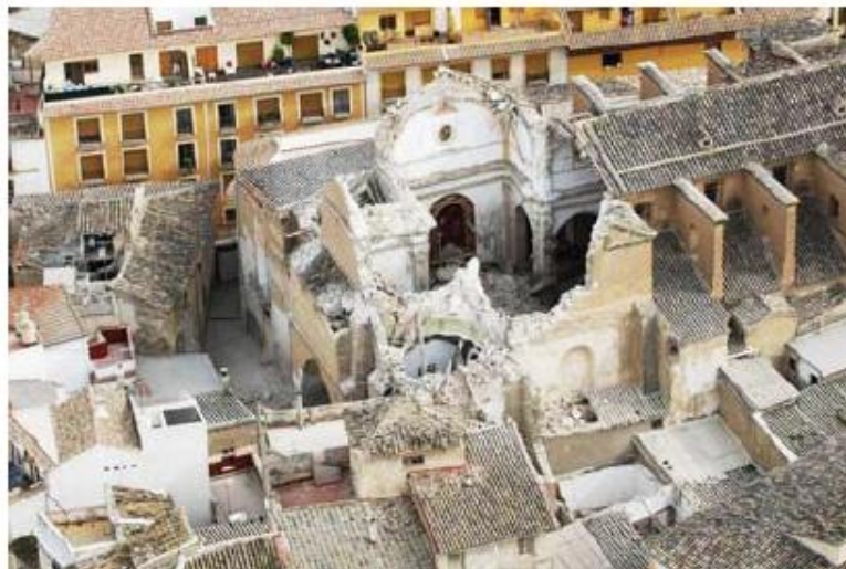
Figura 2.12. Derrumbamiento de la nave de crucero de la iglesia de Santiago.
