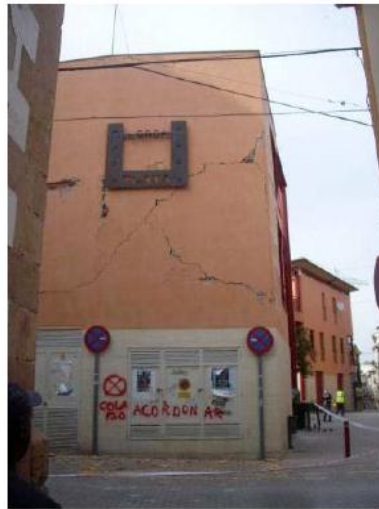
Figura 2.23. Grietas por cortante en forma de aspa en el cerramiento de un edificio público de muy reciente construcción en Lorca.
