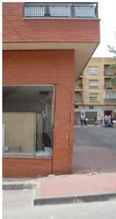
Figura 2.22. Torsión motivado por el efecto rigidizante de los muros medianeros de un edificio de esquina con grandes deformaciones permanentes en el pilar de la esquina más alejada del centro de rotación. Este edificio se derrumbó a los pocos días de realizar las fotografías.
