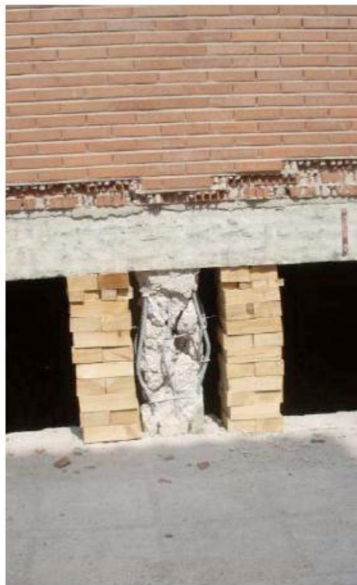
Figura 2.19. Pilares corto dañado en edificio de Lorca.
