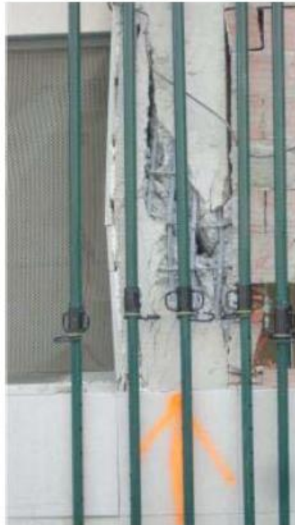
Figura 2.20. Pilar secuestrado por el confinamiento de albañilería de un edificio de Lorca.
