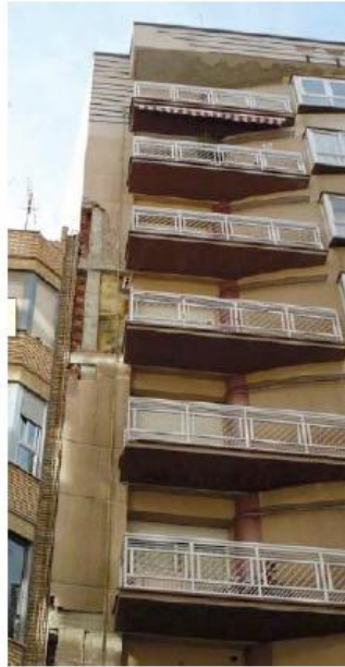
Figura 2.21. Daños por embestimiento en edificios de altura en Lorca.
