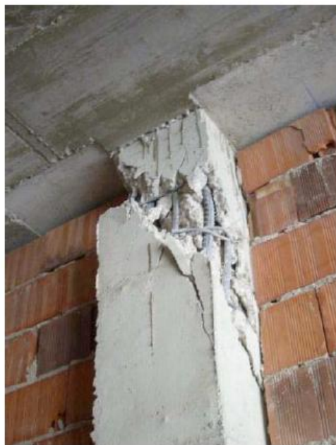
Figura 2.17. Daño frágil por cortante en cabezas de pilares de plantas bajas observados en varios edificios. Esto es un mecanismo inestable de daño de gran peligrosidad.
