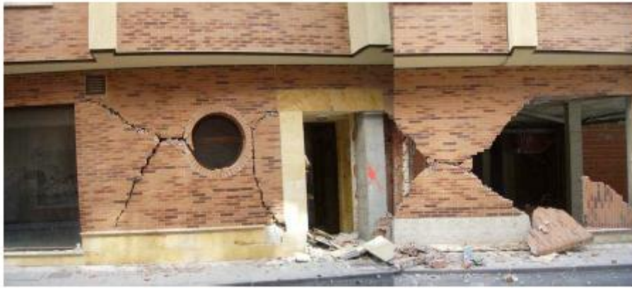
Figura 2.16. Daños por cortante en el cerramiento no estructural de planta baja de un edificio de viviendas. El cerramiento ha entrado en carga resistiendo los esfuerzos horizontales de la estructura, por lo que muestra los mismos mecanismos de daño que las estructuras murarias, fallando por cortante con grietas en forma de aspa.
