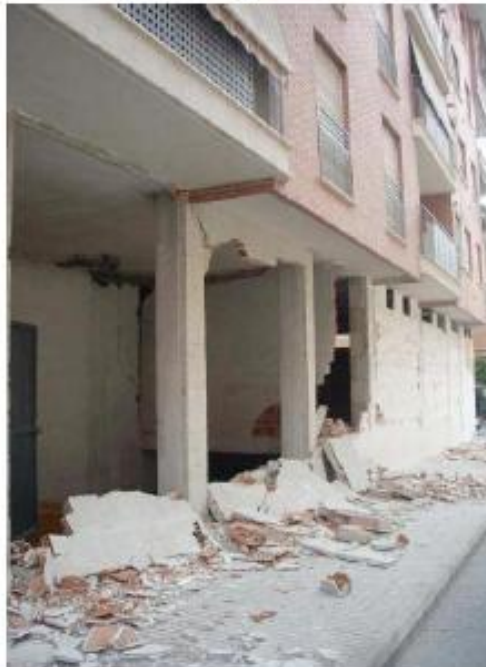
Figura 2.15. Daños a cerramientos de plantas bajas en un edificio de vivienda con locales comerciales de gran esbeltez.
