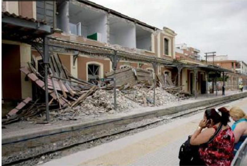
Figura 2.11. Vuelco de estructura muraria de fábrica de ladrillo en la estación de Lorca.
