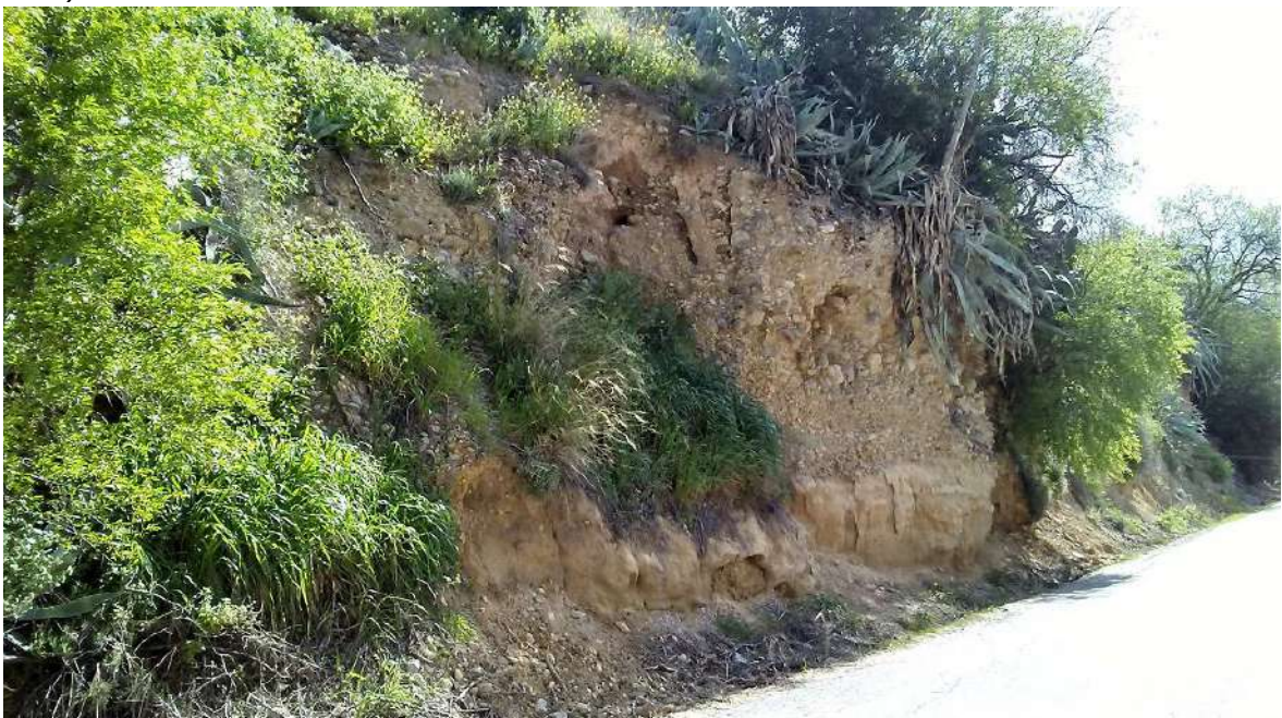
Figura 3.10: Detalle de caídas de bloques, Conglomerados.
