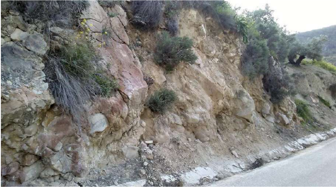
Figura 3.11: Zona de caída de rocas areniscas y brechas.
