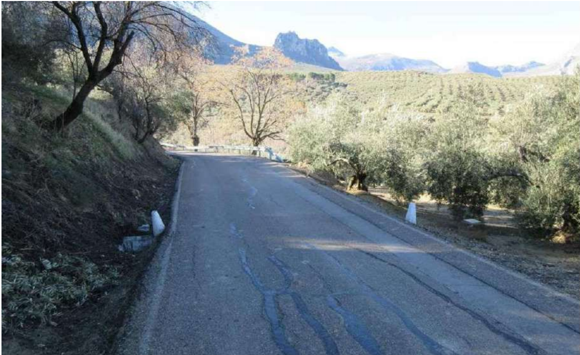
Figura 3.8: Detalle de grietas longitudinales por fenómenos de expansividad.
