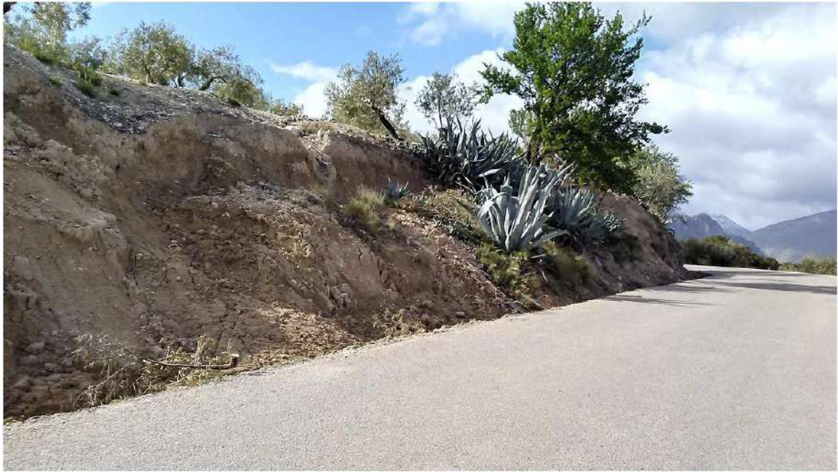
Figura 3.6: Detalle de pequeños deslizamientos en talud.
