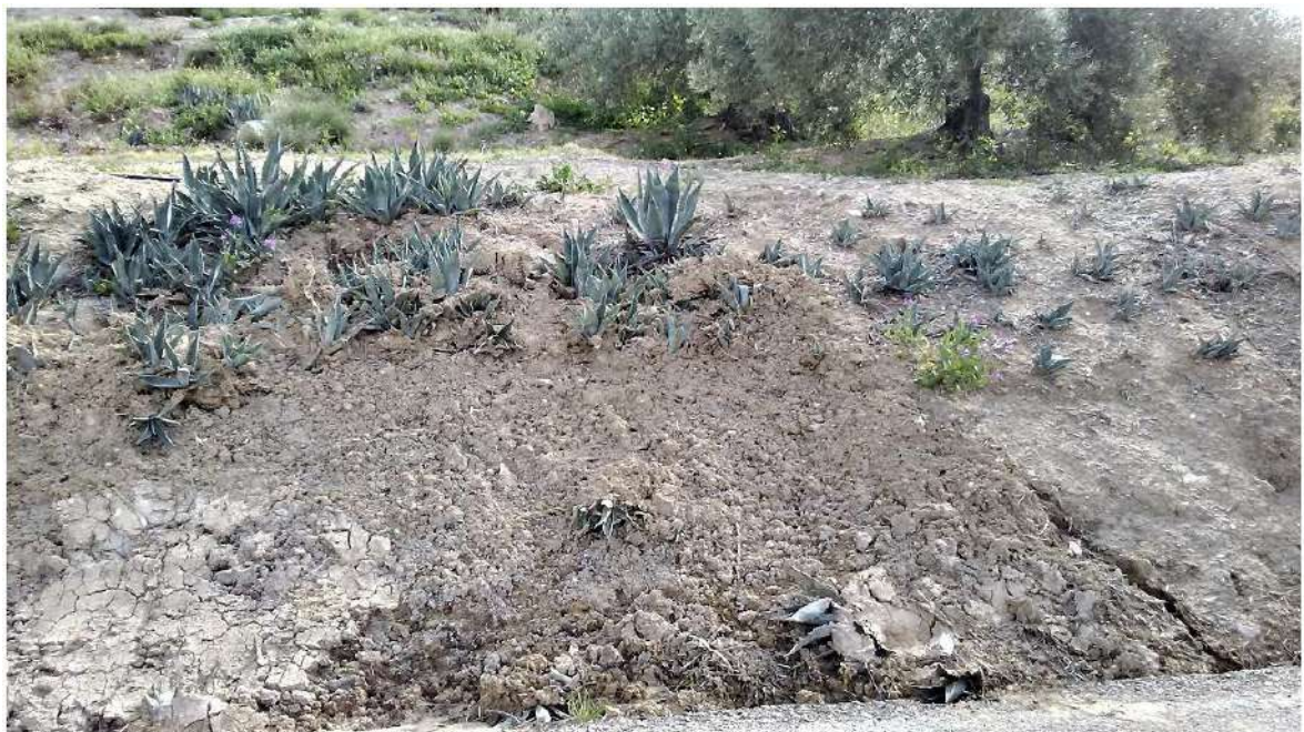
Figura 3.7: Detalle de inestabilidad en talud.
