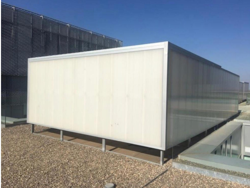
Figura 28. Estructura que protege las máquinas de climatización.
