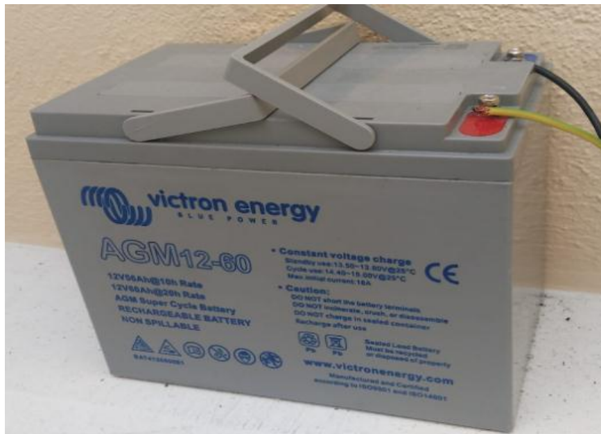
Ilustración 2.8 - Batería de gel AGM de Victron Energy, instalada en el prototipo
