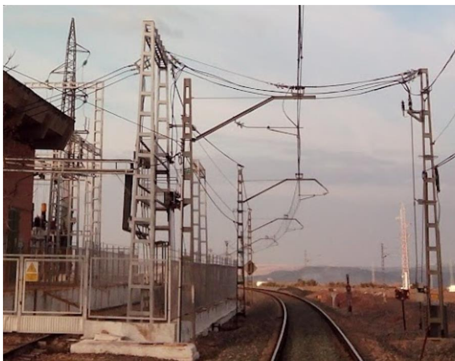
Figura 24: Pórtico de feeder de la subestación de Grañena. Fuente: Manuel Miró.
