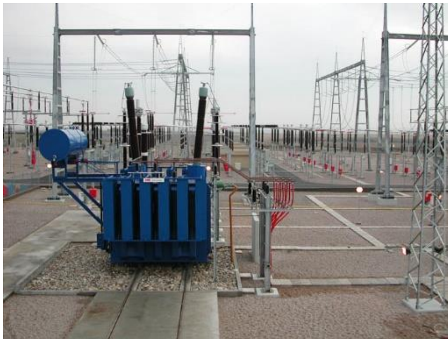
Figura 20: Subestación de tracción. Fuente: CYMI.
