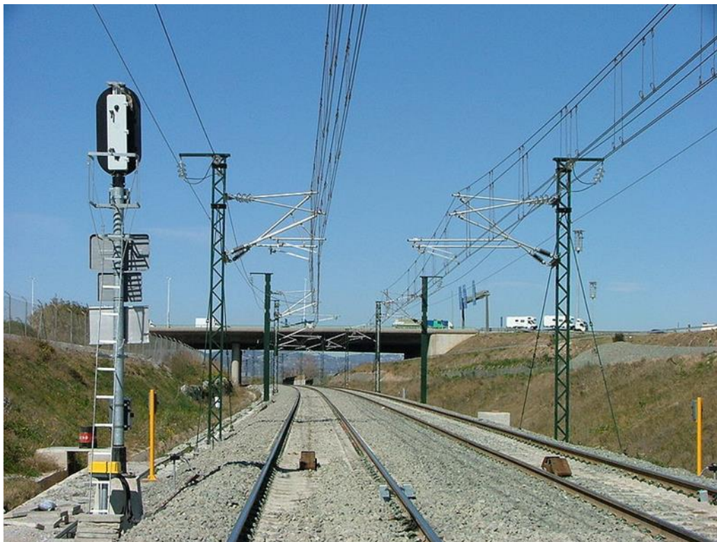
Figura 37: Vías con doble sustentador. Fuente: RENFE.
