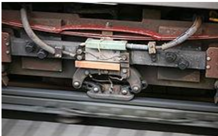
Figura 31: Ejemplo de frotador sobre tercer carril. Fuente: ADIF.
