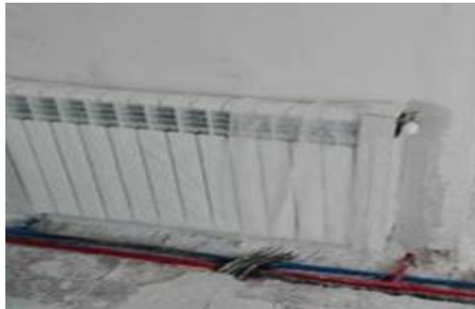
Ilustración 17. Radiador de calefacción hydronic.
