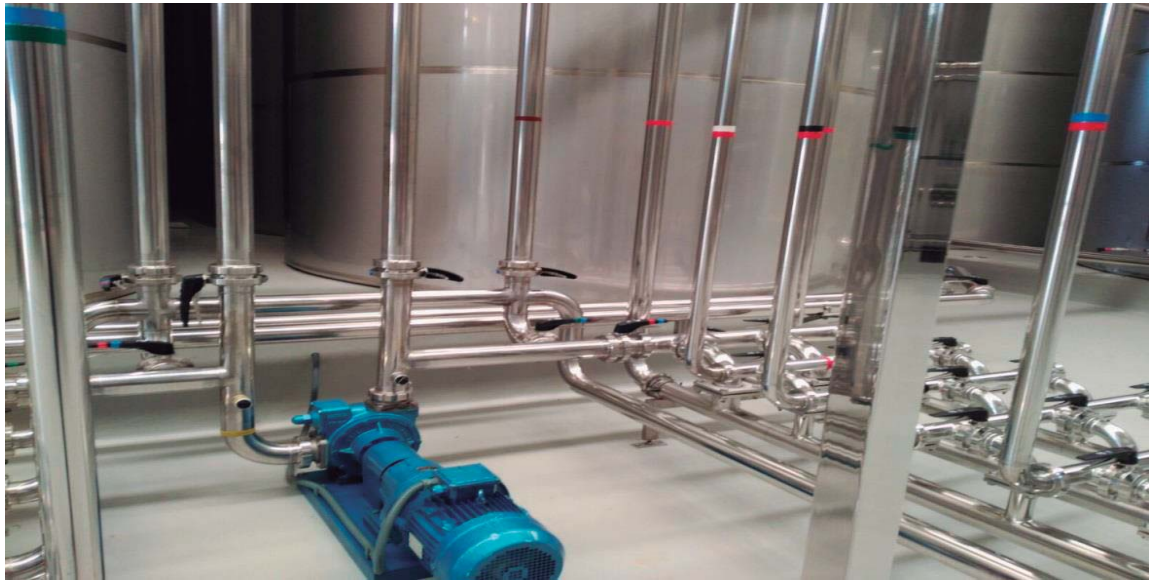
Ilustración 29: Sistema de válvulas de los depósitos de aceite en Picualia. Fotografía del autor.
