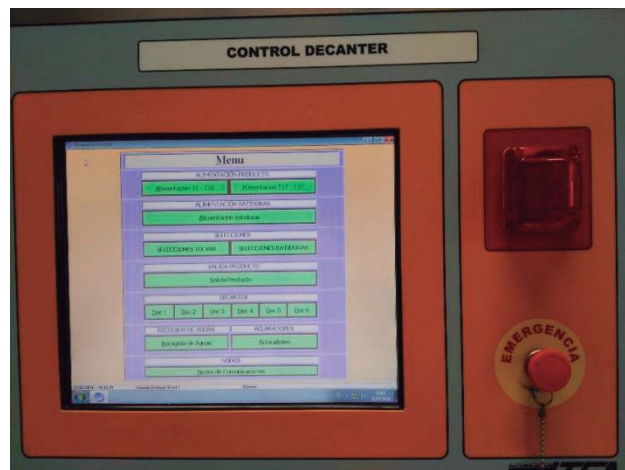
Ilustración 21: Detalle del sistema informático de control de los molinos. Fotografía del autor.
