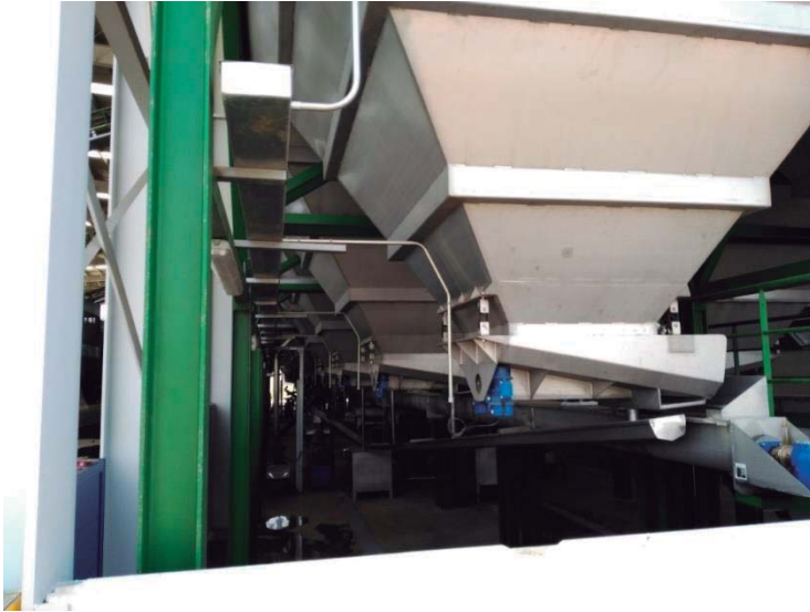
Ilustración 18: Tolvas de alimentación de molinos. Fotografía del autor.
