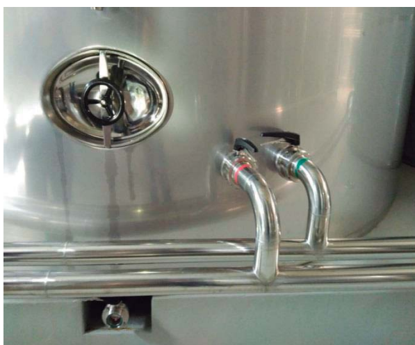
Ilustración 28: Válvulas de salida y entrada de un depósito en las instalaciones de Picualia. Fotografía del autor.
