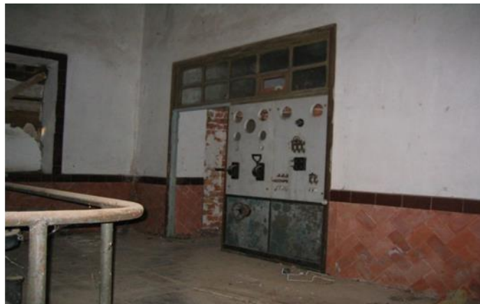
Ilustración 5 Interior de la sala de máquinas
