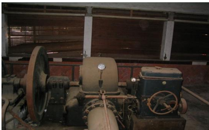
Ilustración 4 Interior de la sala de máquinas
