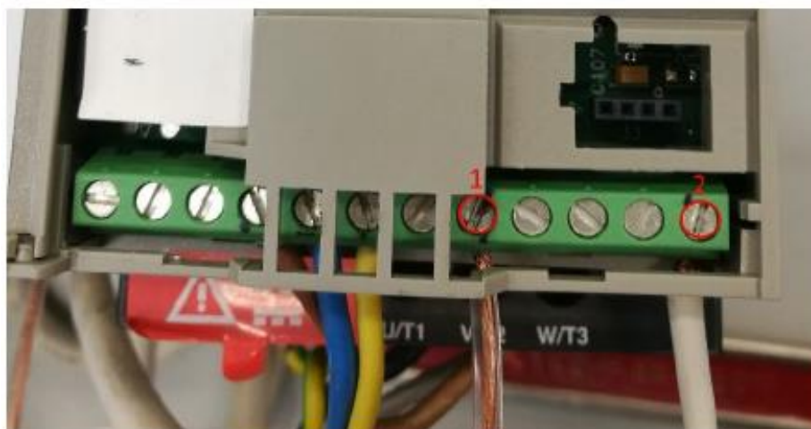
Figura 70: Conexión final de carrera al variador de frecuencia. Marca 1 corresponde a la toma de tierra 0V y la Marca 2 15V [26]
