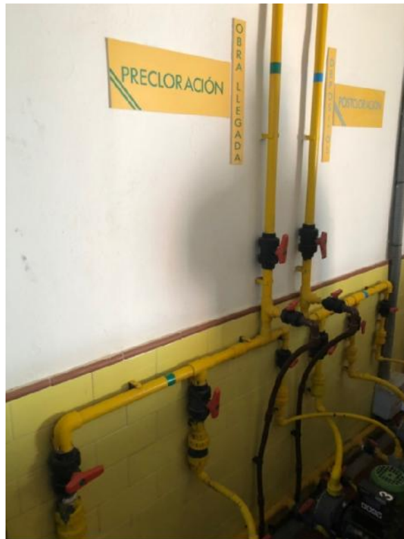
Ilustración 20. Instalación de precloración ETAP Linares (1)
