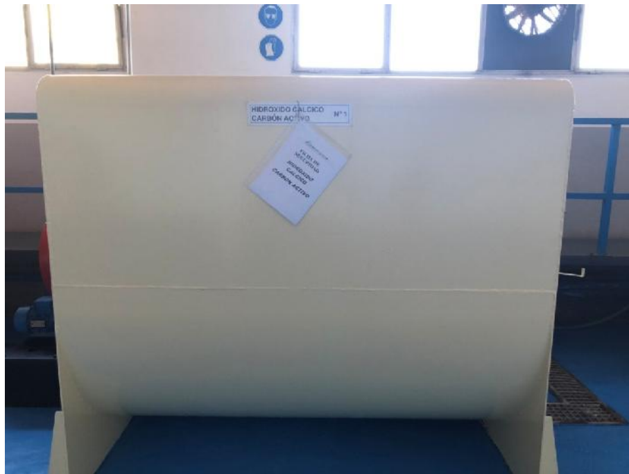
Ilustración 16. Depósitos de hidróido de calcio y carbón activo en polvo ETAP de Lianres (2)
