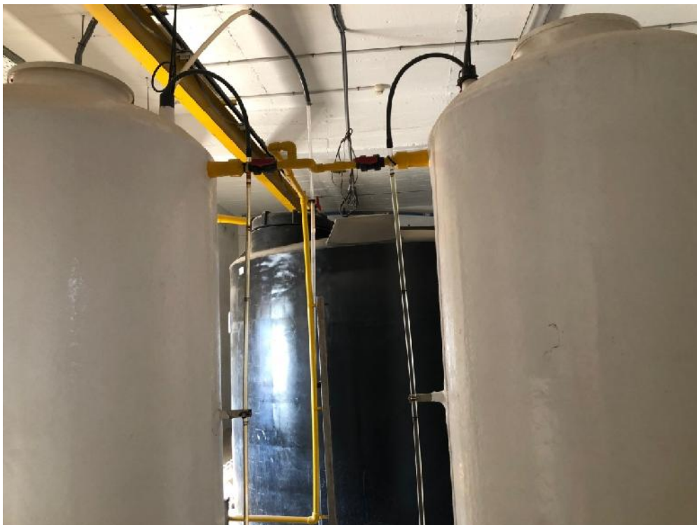
Ilustración 19. Tanque almacenamiento hipoclorito sódico ETAP Linares
