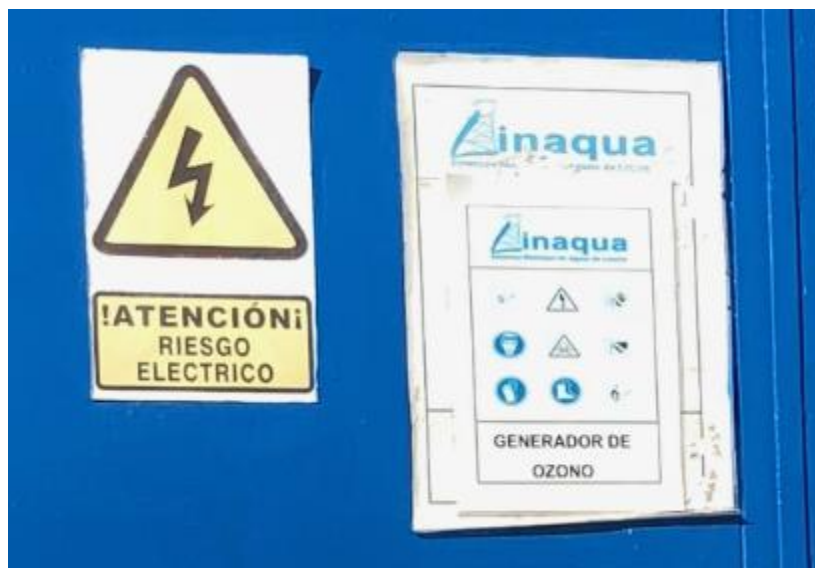
Ilustración 6. Generador Ozono ETAP Linares (2)
