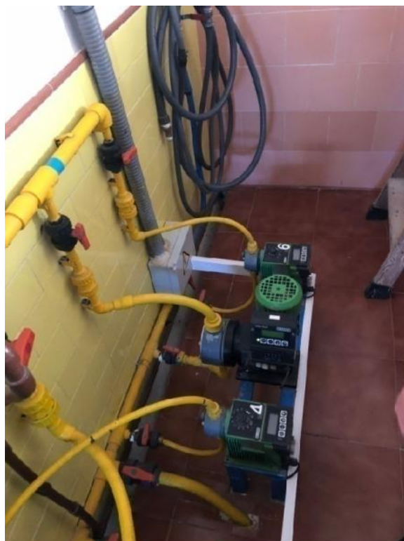
Ilustración 32. Instalación de postcloración ETAP Linares (2)
