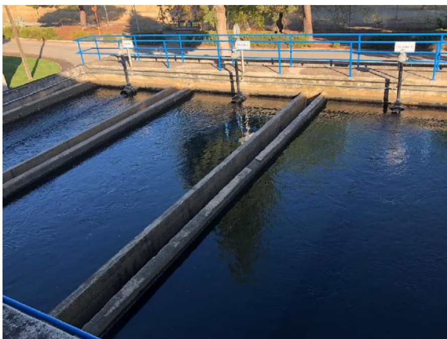
Ilustración 29. Depósitos de filtración ETAP Linares (2)
