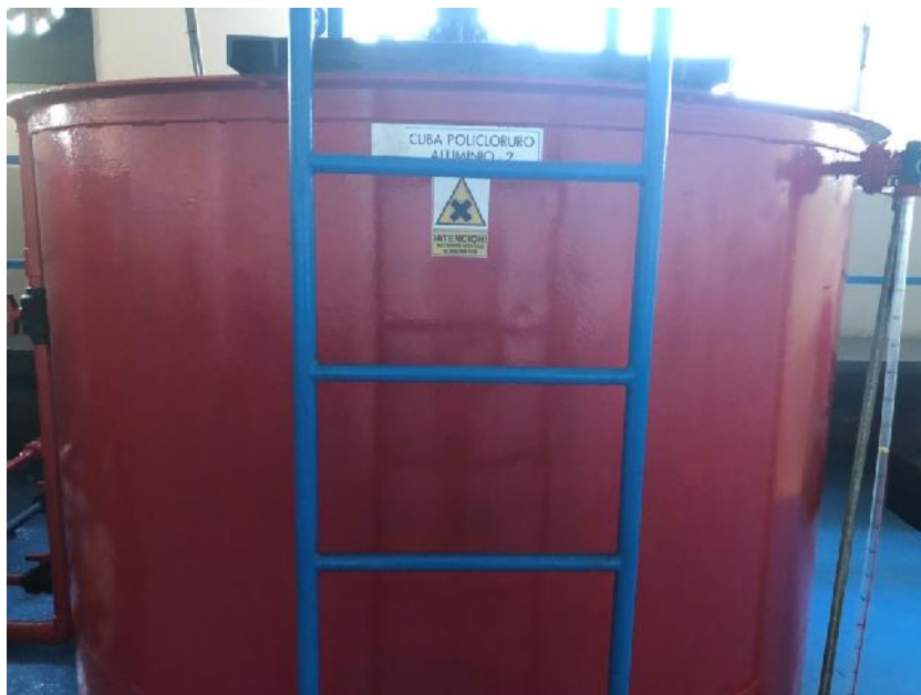
Ilustración 10. Depósitos Policloruro de Aluminio ETAP Linares (2)
