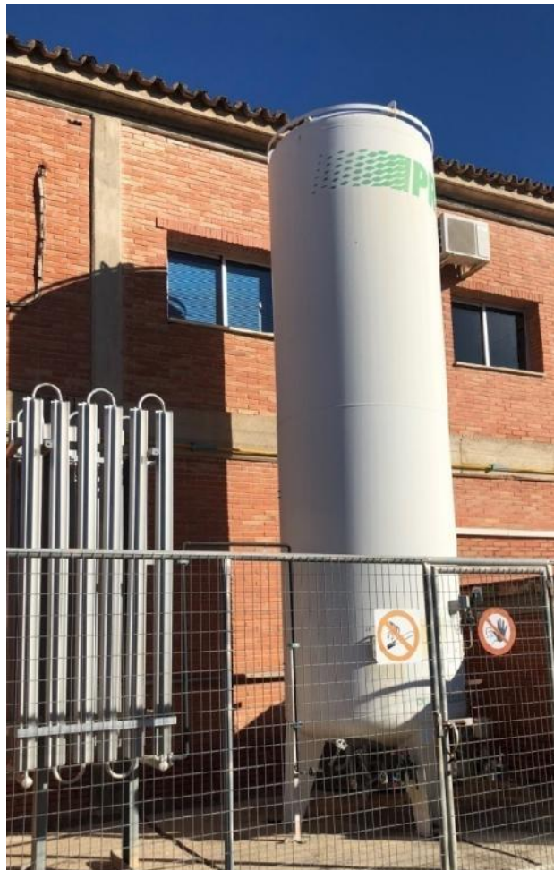
Ilustración 7. Depósito de oxígeno ETAP Linares
