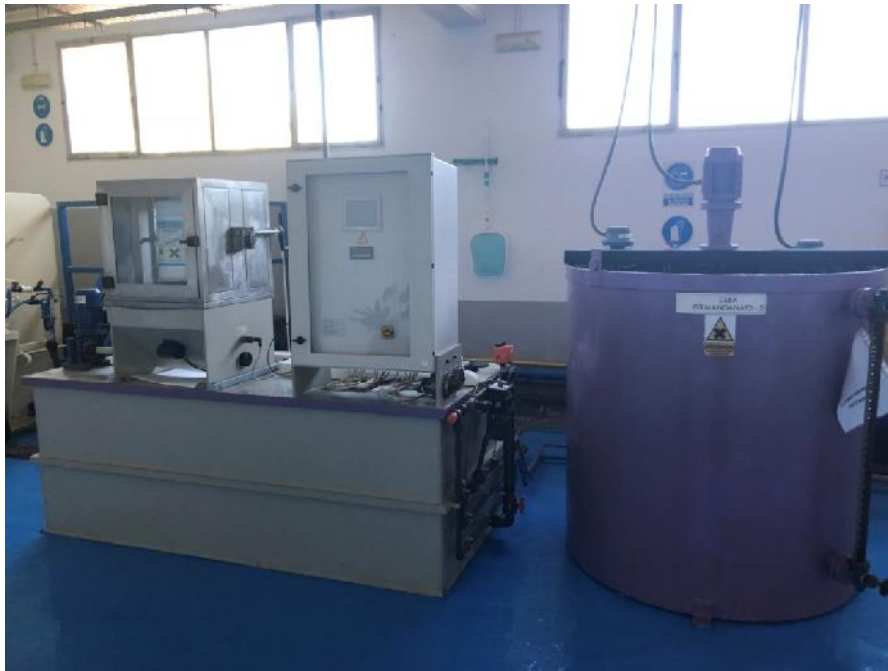
Ilustración 12. Dosificador de permanganato de potasio y cuba
