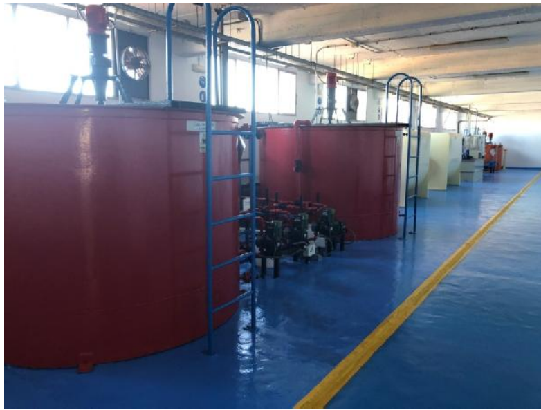
Ilustración 11. Depósitos Policloruro de Aluminio ETAP Linares (3)
