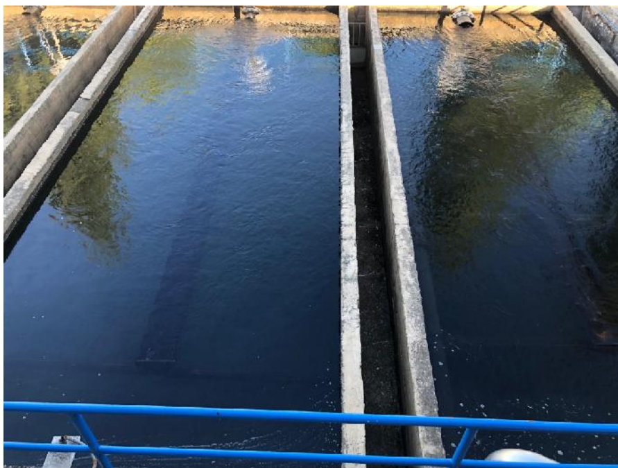
Ilustración 28. Depósitos de filtración ETAP Linares (1)
