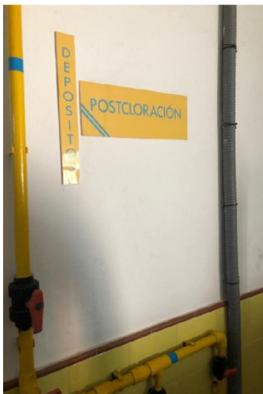
Ilustración 31. Instalación de postcloración ETAP Linares (1)
