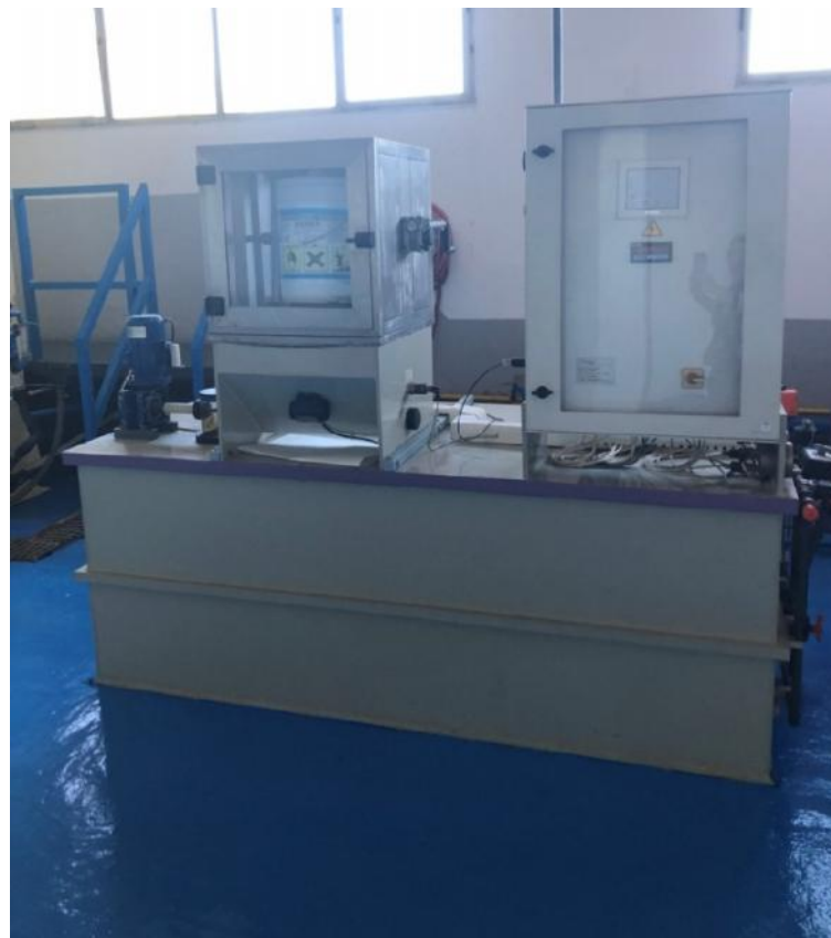
Ilustración 13. Dosificador actual permanganato de potasio ETAP Linares
