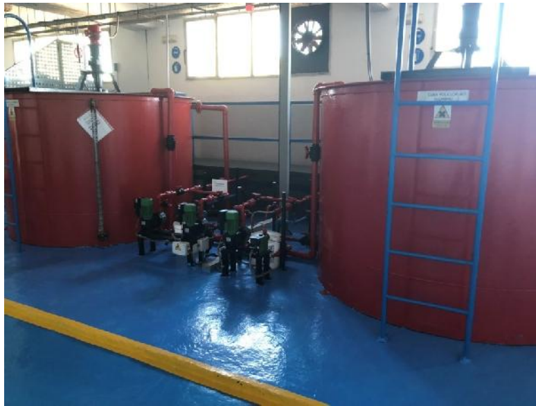
Ilustración 9. Depósitos Policloruro de Aluminio ETAP Linares (1)
