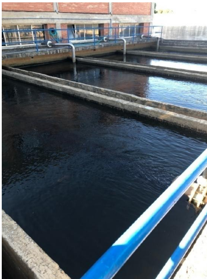
Ilustración 30. Depósitos de filtración ETAP Linares (3)
