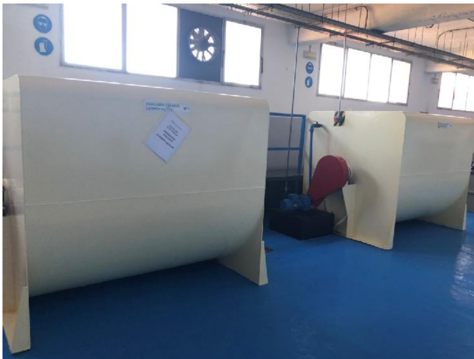
Ilustración 15. Depósitos de hidróxido de calcio y carbón activo en polvo ETAP de Linares (1)
