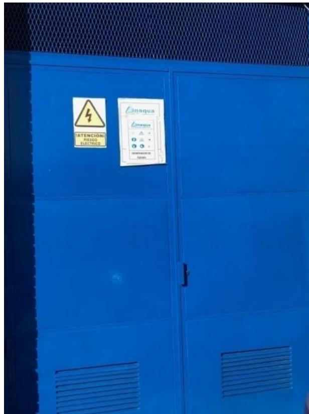
Ilustración 5. Generador Ozono ETAP Linares
