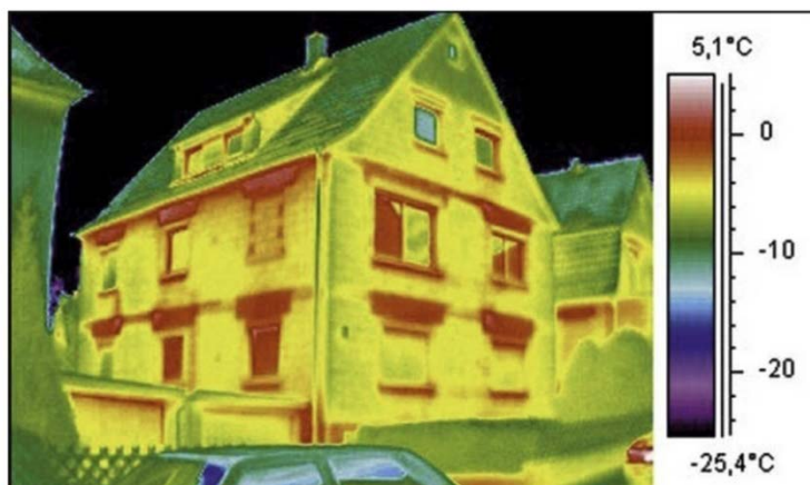
Figura 3.3 Foto termográfica que muestra la pérdidas por puentes térmicos. Fuente: Ecubo Efficiency
