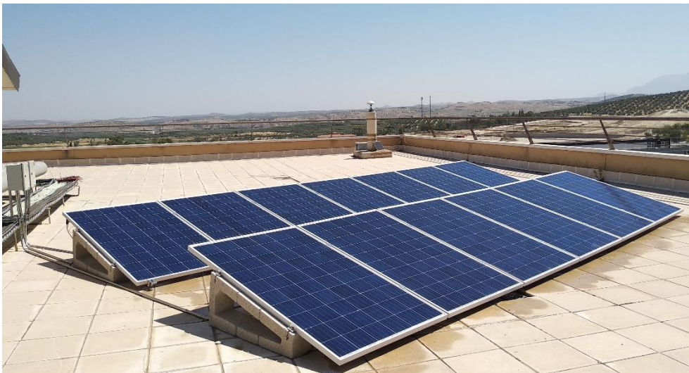
Figura 3.5: Imagen del generador fotovoltaico monitorizado
