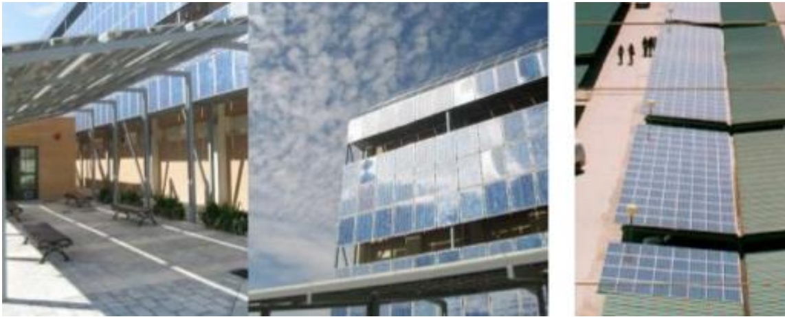
Figura 3.1: Instalaciones fotovoltaicas del proyecto UNIVER
