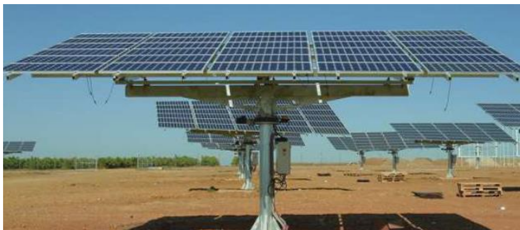
Ilustración 11: Módulos que giran con seguimiento solar
