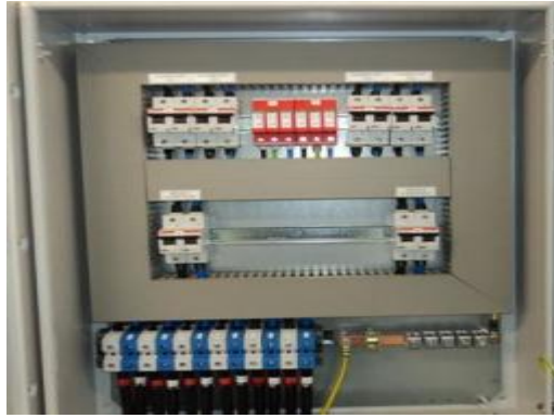
Figura 4.4: Cuadro de continúa de conexión hacia el inversor
