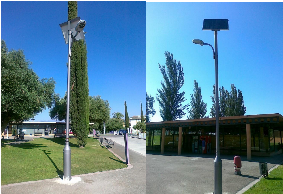
Ilustración 4.10. Farola Solar SolarFix instaladas en el complejo Las Fuentezuelas (SmartCityJaén, 2012)
