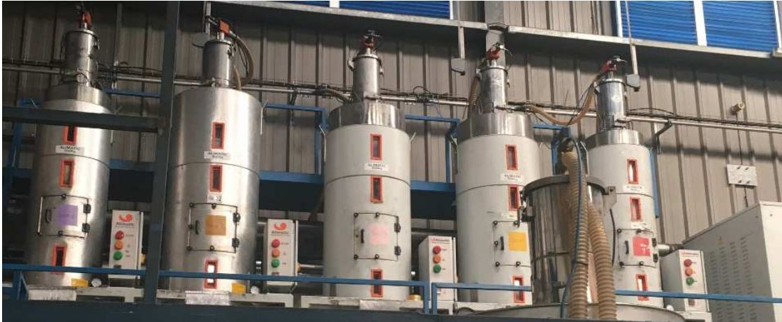
Figura 6.2.2.1. Silos de carga de material. (Fotografía del autor).
