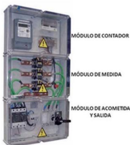
Figura 1.10. Módulos de conexión con la red de baja tensión.
