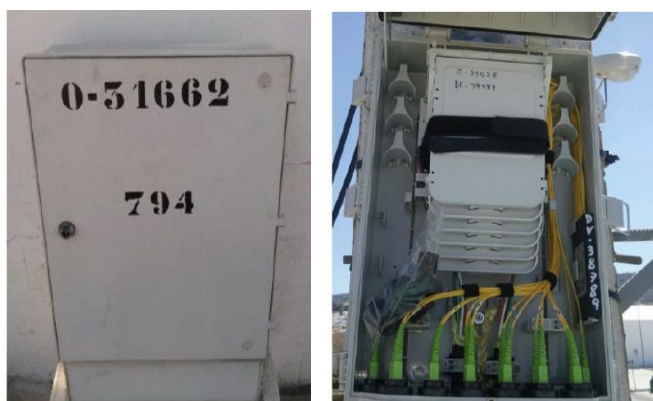
Figura 3.1_. Distribuidor de fibras ópticas.
