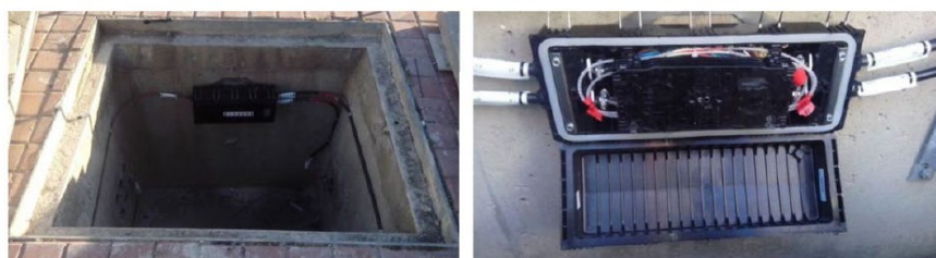
Figura 3.1_. Caja de empalmes.
