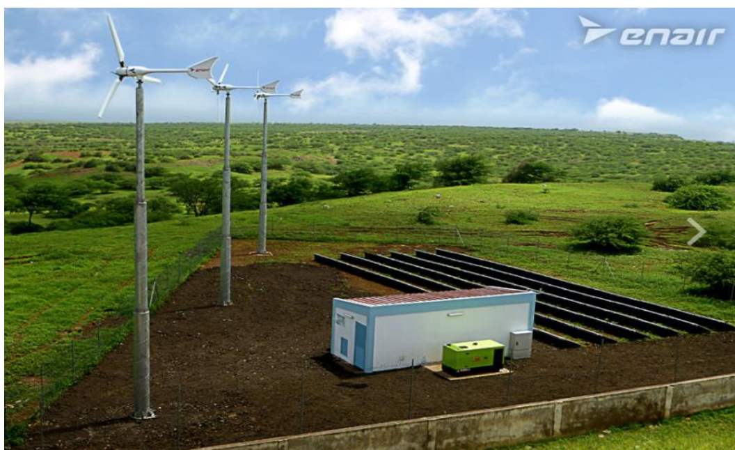
Figura 1.4- Instalación aldea de Cabo Verde. Fuente [5]
