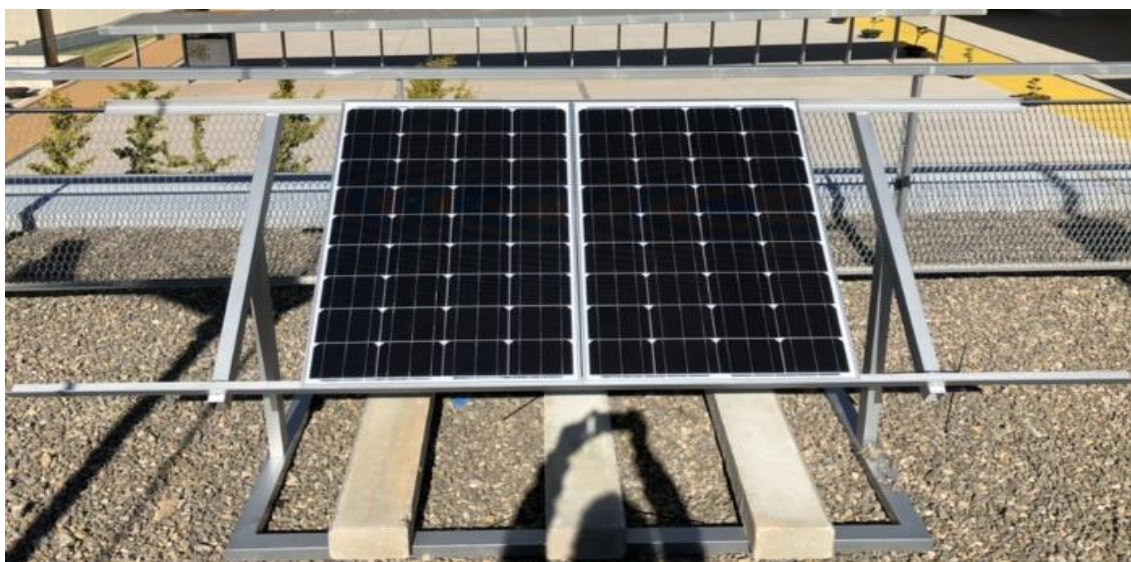
Figura 4.7-Estructura con los dos módulos fotovoltaicos. Fuente propia.
