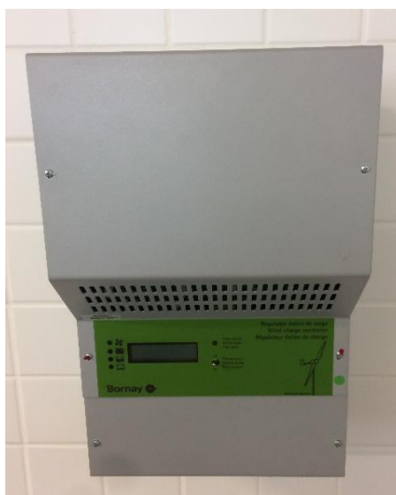
Figura 4.9- Regulador/inversor fijado en pared. Fuente propia.
