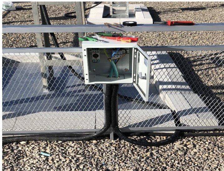
Figura 4.20- Armario de conexión. Fuente propia.
