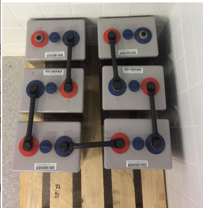
Figura 4.18- Conexión baterías. Fuente propia.
