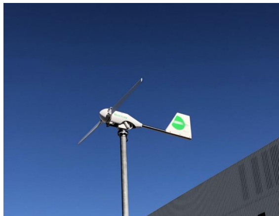
Figura 4.3- Aerogenerador 600 W. Fuente propia.
