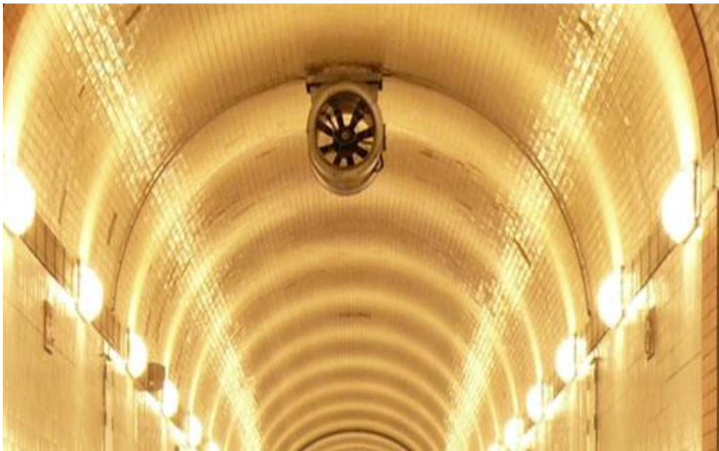
Anejo nº 3. Figura 2: Colocación de los ventiladores en la clave del túnel. Fuente Zittrón
