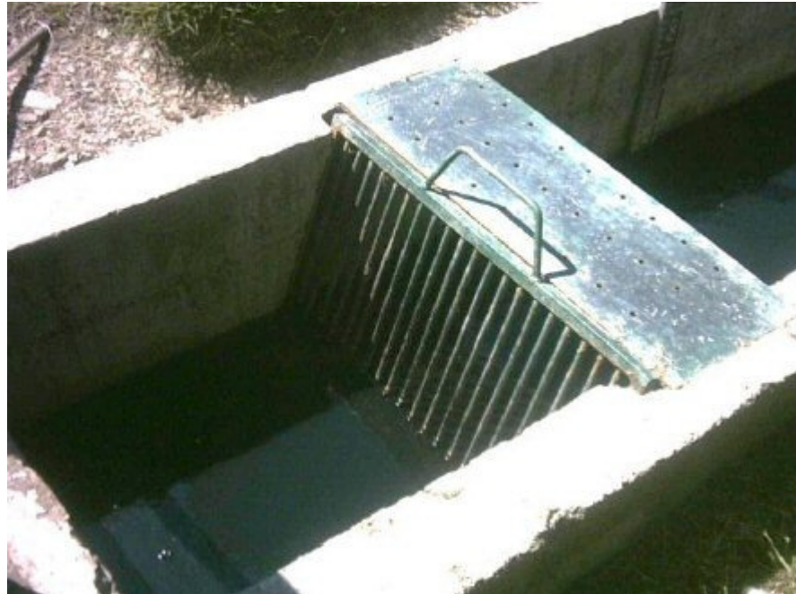
Figura nº 8: Rejillas de desbaste.
