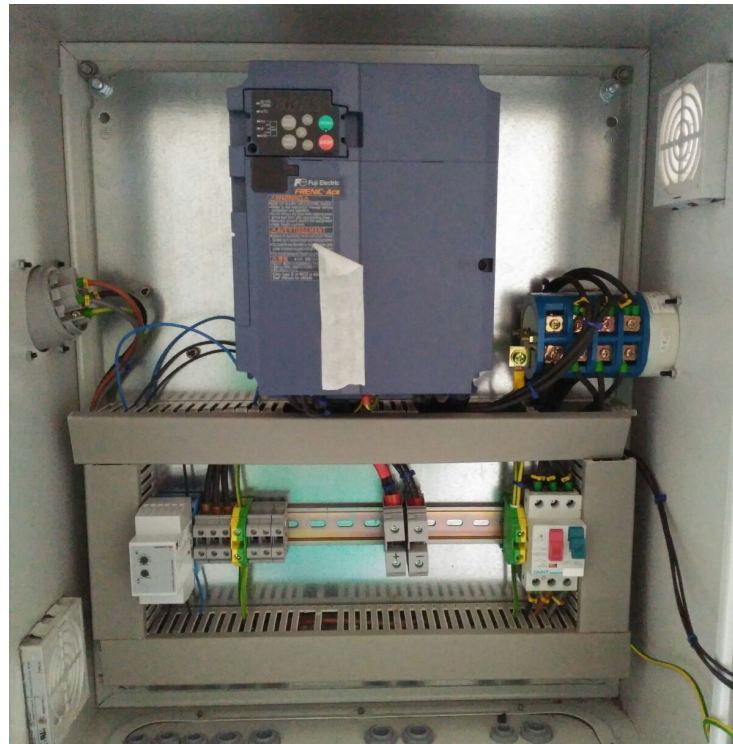
Imagen 9. Cuadro eléctrico de alterna.
