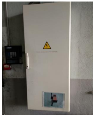
Ilustración 6. Cuadro de distribución secundario de baja tensión
