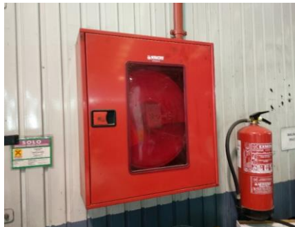
Ilustración 4. Equipos pertenecientes a la instalación contra incendios
