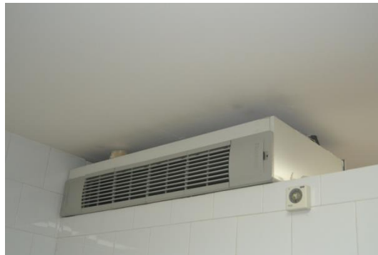
Figura 17: Detalle de fancoils
