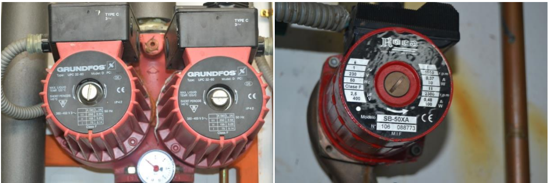
Figura 15: Instalaciones de impulsión
