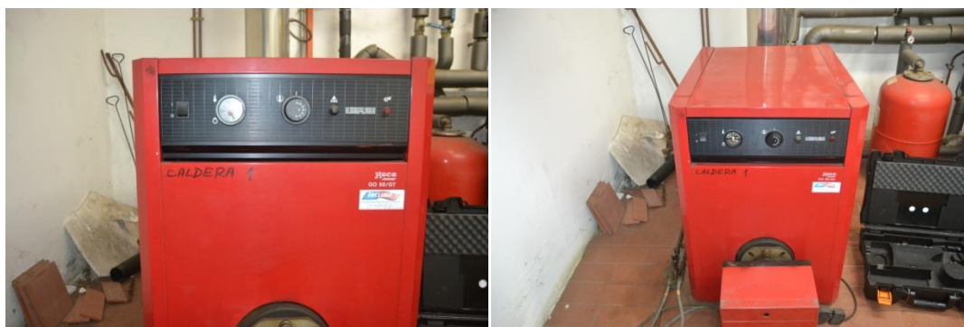
Figura 18: Generador de ACS
