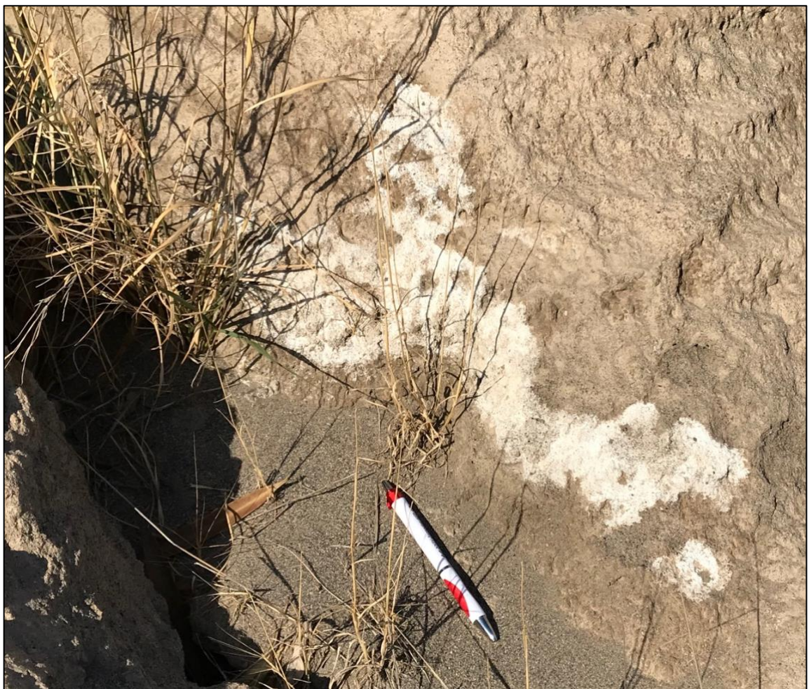
Figura 14: Costras blancas sobre arenas en la presa de lodos de La Manzana.
