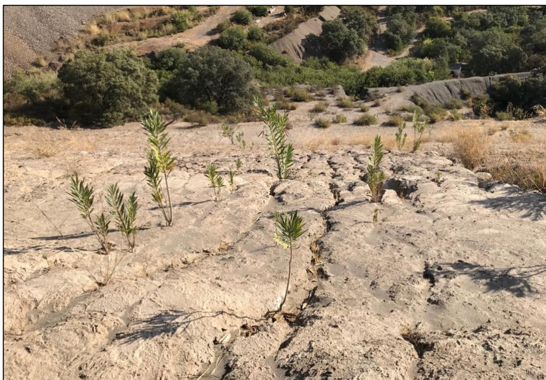
Figura 27: Presencia de cárcavas en el talud de la presa de lodos de La Manzana.
