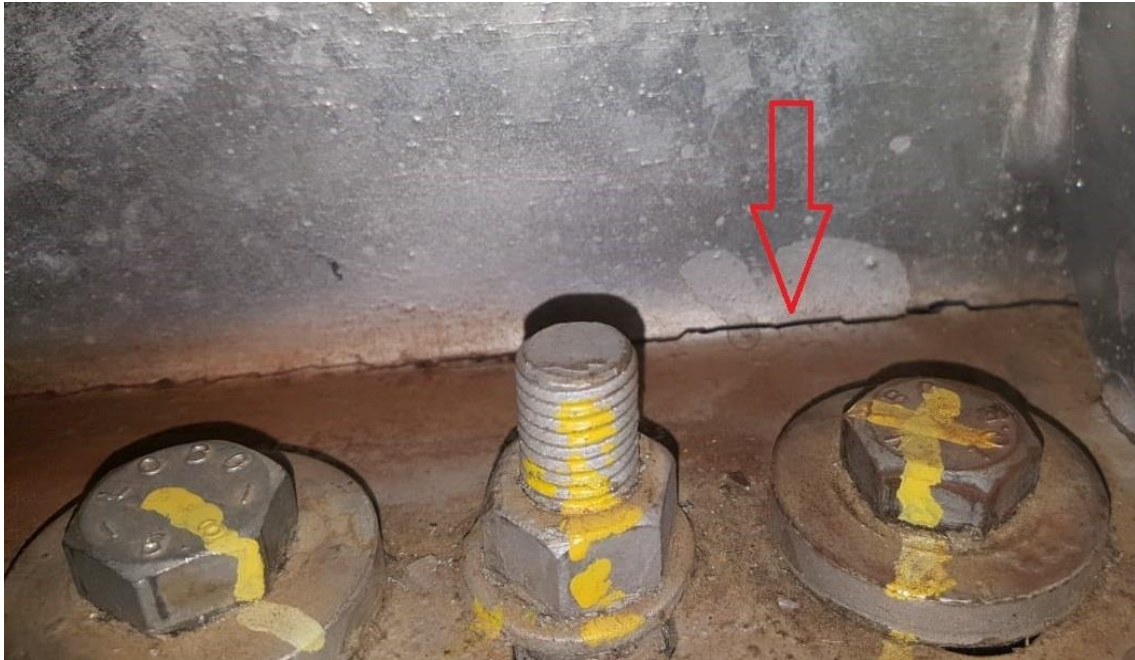
Ilustración 51.- Fisura en la unión de la horizontal con la vertical de la viga nº 2.
