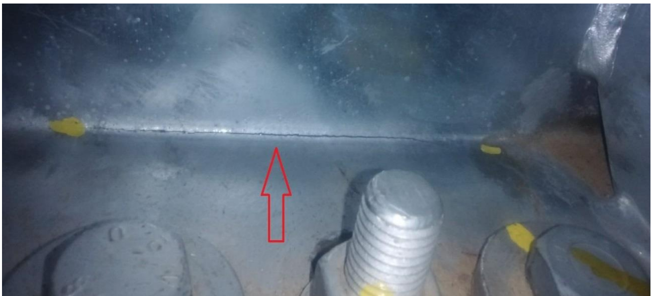
Ilustración 50.- Fisura en la unión de la horizontal con la vertical de la viga nº 1.
