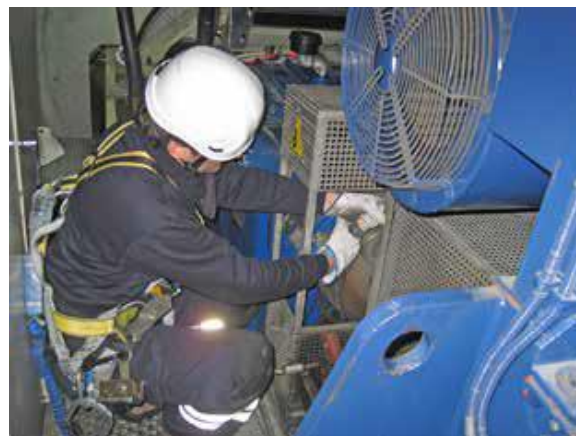
Ilustración 18.- Sistema de freno manual del eje rápido del aerogenerador (ALSTOM).
