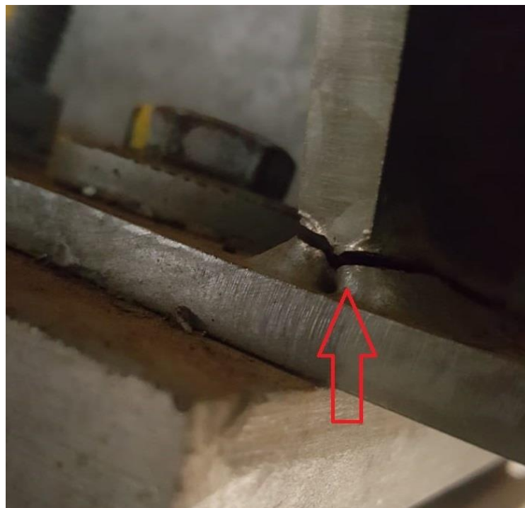
Ilustración 48.- Fisura en la soldadura de la cartelera de la viga nº 2.
