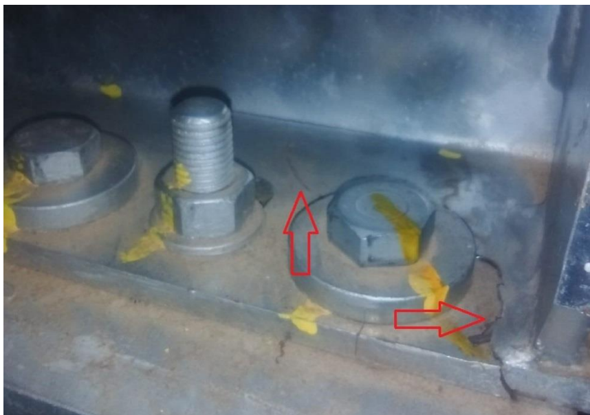
Ilustración 43.- Fisuras entre los agujeros de los taladros de la viga del transformador nº 1.
