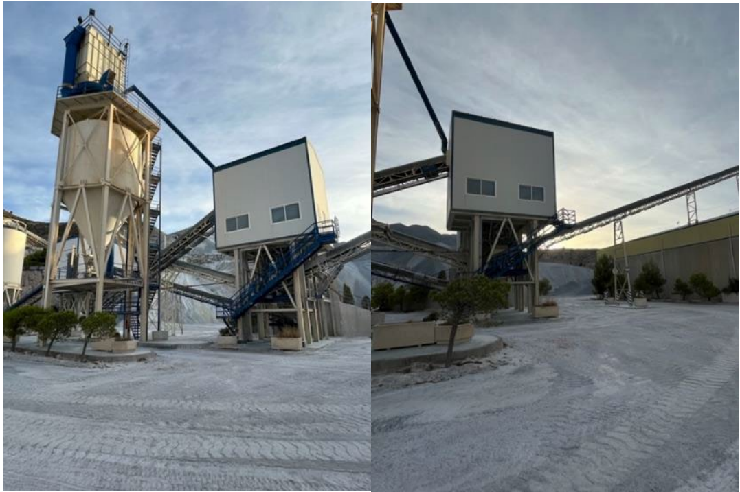
Imagen 8. Silo 100 micras, filtro de mangas, cribas, cinta transporte a cribas.
