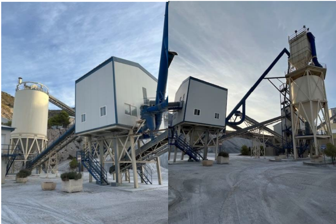
Imagen 7. Silo principal, caseta molinos, silo 100 micras y filtro de mangas.
